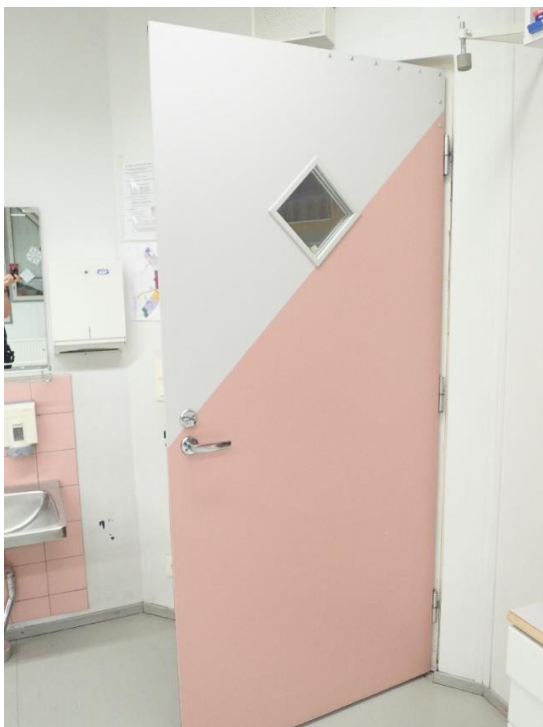
Kuva 22. Sisäovien malli. Sisäovissa on todettu irronneita tiivisteitä ja maalipintavaurioita tiloissa 123 ja 138. Tilassa 123 sisäoven karmeissa oli pientä mekaanista vauriota, mutta se ei vaikuttanut oven toimivuuteen
