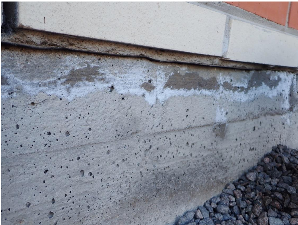
Kuvat 14 ja 15. Julkisivut ovat koulun pihan puolella ja puupanelointien osalta siistit. Sokkeleiden yläosissa on kalkkihärmää kantavan alapohjan AP1 alueella.
