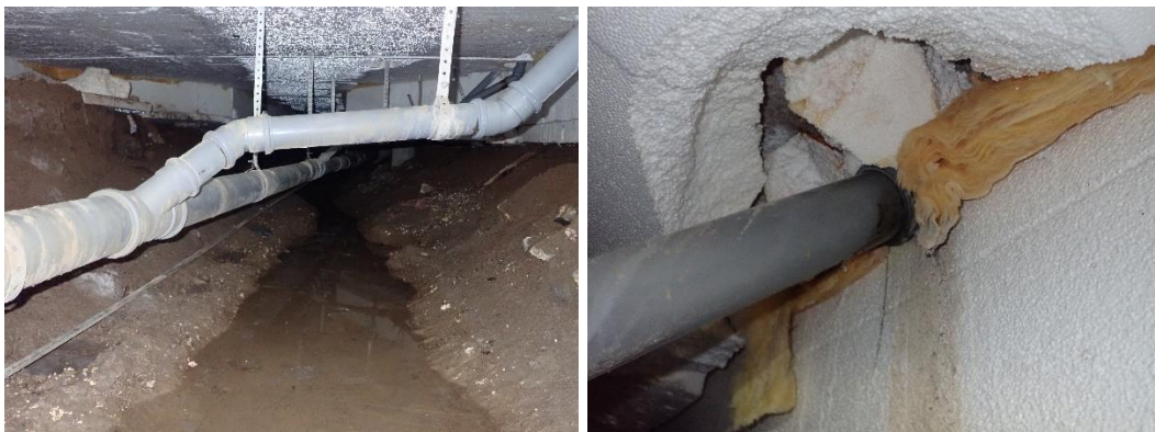
Kuvat 4. ja 5. Ryömintätilan pohjalle on kertynyt vettä, joka tiivistyy yläpuolisen eristeen pintaan. Alapohjan läpivientejä ei ole tiivistetty ryömintätilan puolelta ilmatiiviisti.
