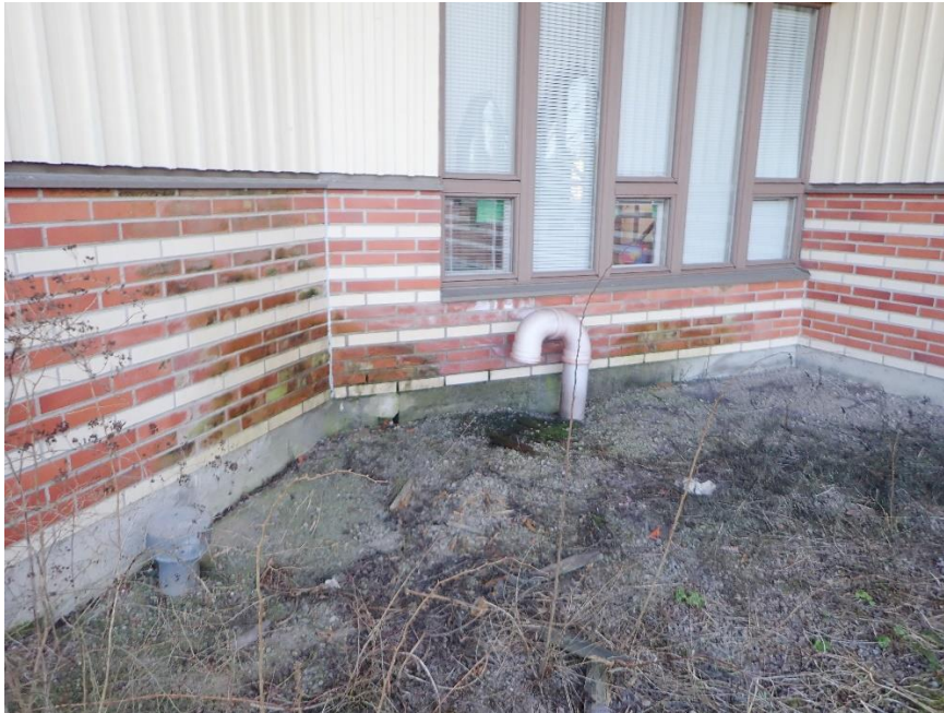
Kuva 16. Muilla julkisivuilla, joissa on istutusalueita lähellä ulkoseinää, julkisivujen alaosissa on sadevesiroiskeiden aiheuttamaa likaa ja leväkasvustoa.
