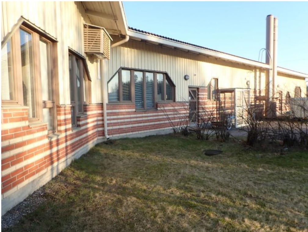
Kuva 30. Kasvillisuutta on sokkelin pinnassa asti.
