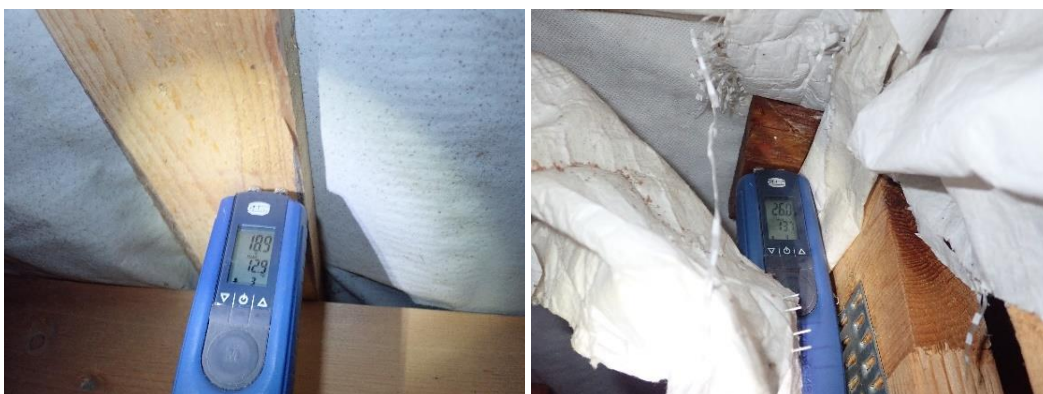
Kuvat 38 ja 39. Ruodelaudoitus on paikoin kastunut.
