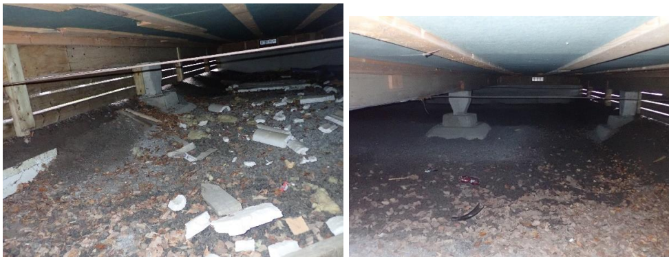
Kuvat 5 ja 6. Ryömintätilassa on runsaasti orgaanista materiaali ja roskaa
