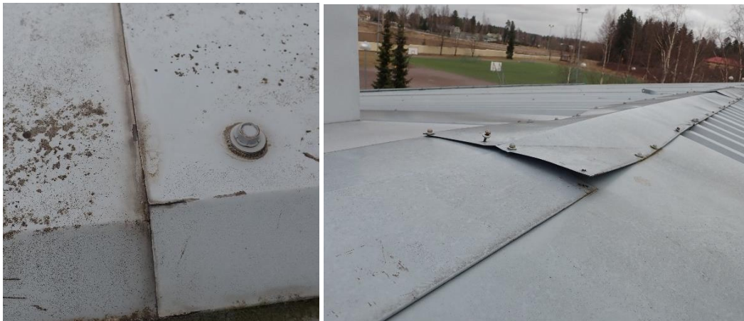
Kuva 30. Harjapellin liittymien kittaukset ovat halkeilleet ja ruuvit ovat paikoin irti tai ruosteessa.
