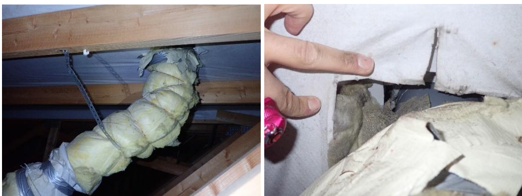
Kuvat 40 ja 41. Läpiviennit eivät ole tiiviitä.
