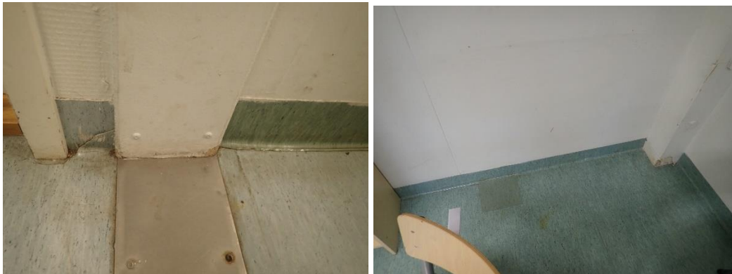
Kuvat 12 ja 13. Pinnoitteen seinäliittymässä on paikoin halkeamia ja koteloinnin alaosa on vaurioitunut.
