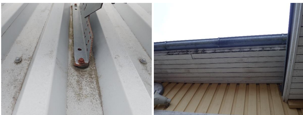
Kuva 35. Kulkusillan kiinnitykset ovat ruostuneet. Räystäskourujen viereinen lauta on vaurioitunut.
