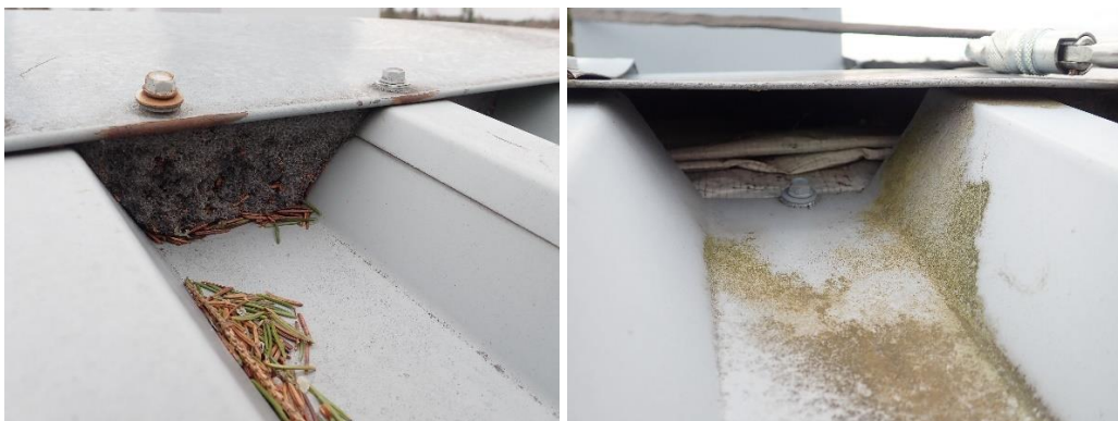
Kuvat 31 ja 32. Harja- ja katepellin raot on paikoin täytetty vaahтомуovilla. Aukinaisissa kohdissa aluskatetta ei ole limitetty pellin alle.
