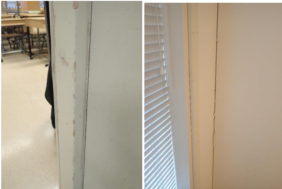
Kuvat 28 ja 29 Sisäovien ja ikkunoiden liittymissä on paikoin halkeamia.
