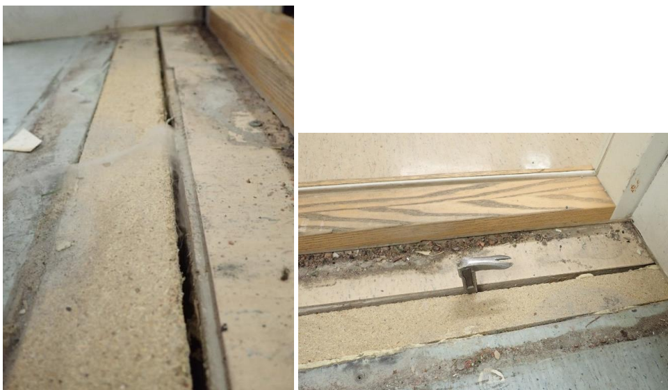
Kuvat 16 ja 17. Tilan P06 oven kynnyksen peltiastian alla olevasta lattiasaumasta todettiin lievää ilmavirtaa sisätiloihin päin merkkiainesavun avulla.
