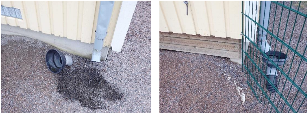
Kuvat 23 ja 24. Sadevettä ohjautuu sokkelin vierelle.
