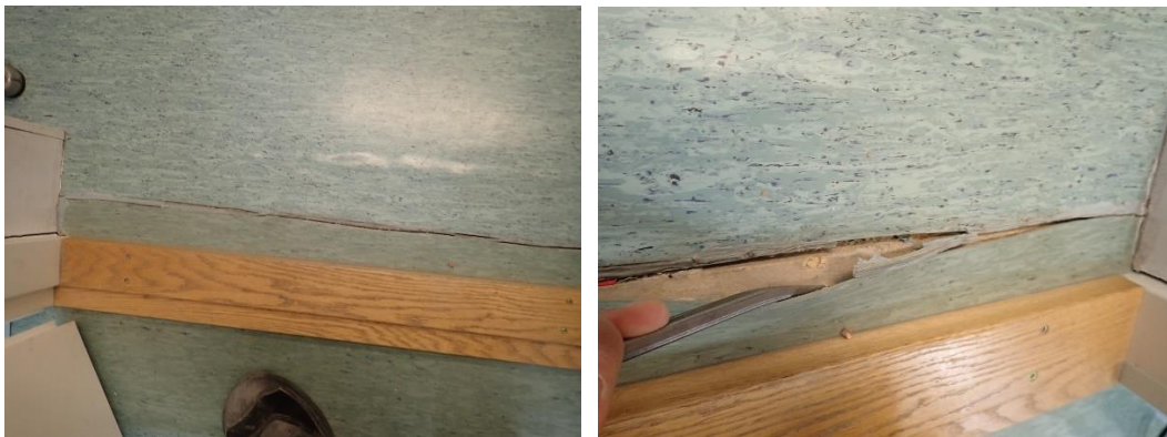
Kuvat 14 ja 15. Pinnoite on irti lattiasauman kohdalla.
