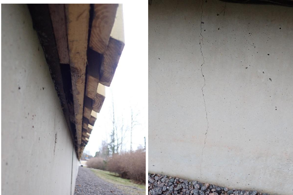
Kuvat 21 ja 22. Ulkoverhouslaudoitus. Sokkelissa on havaittavissa paikoin halkeamia.
