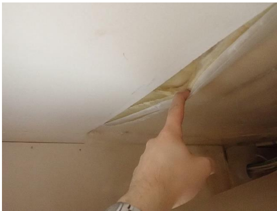
Kuva 52. Yläpohjan höyrynsulku on avoin kipsilevyn katkaisukohdassa.
