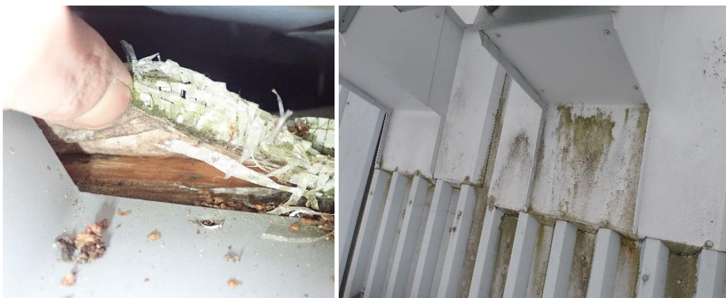
Kuvat 33 ja 34. Aluskatteen koolaus on kastunut. Päätelaitteiden kohdalla peltikate on sammaloitunut.
