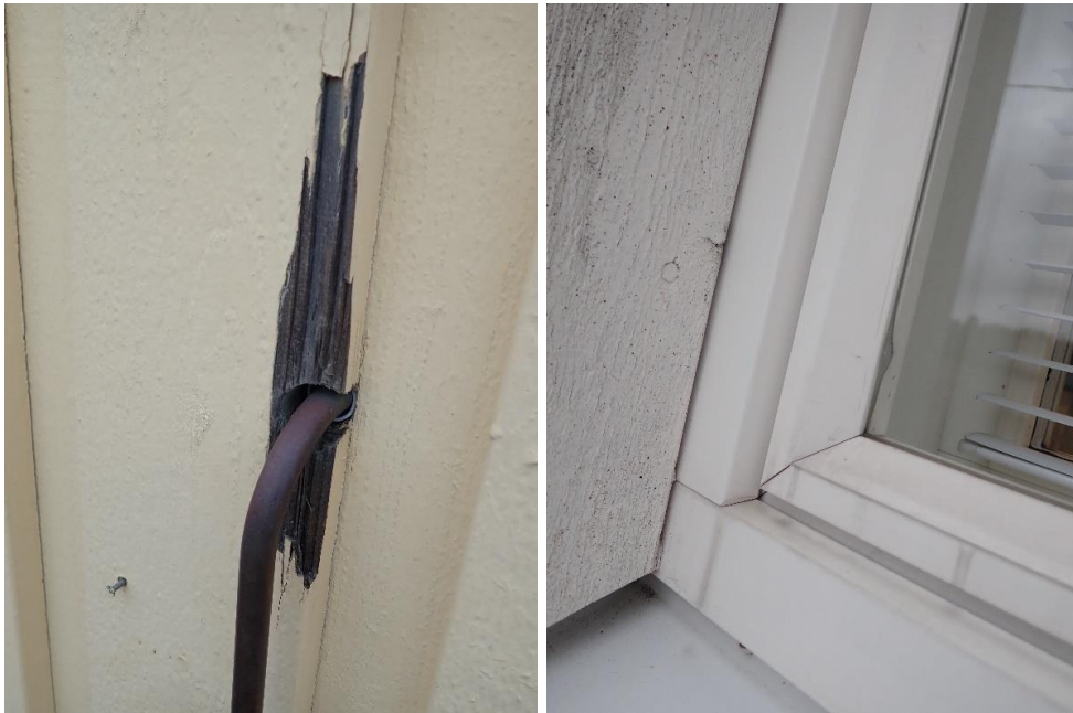
Kuvat 19 ja 20. Ulkoseinän julkisivulaudoitus on vaurioitunut IV-koneiden vedenpoistoputken kohdalla. Ikkunat ovat ulkoapäin hyvässä kunnossa.
