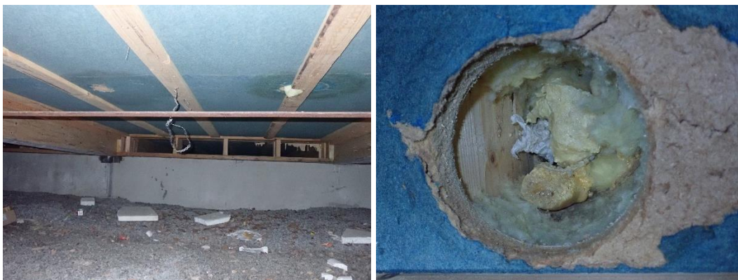
Kuvat 9 ja 10. Alapohjassa on vanhoja kosteusjälkiä läpivientireikien kohdilla.
