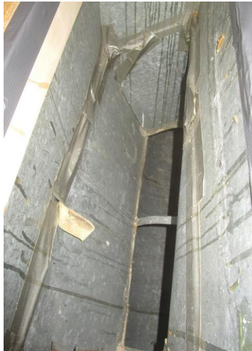
Kuva 6. Suorakaiteen muotoisten tuloilmakanavien liitoskohdissa oli paikoin vanhoja teippauksia.
