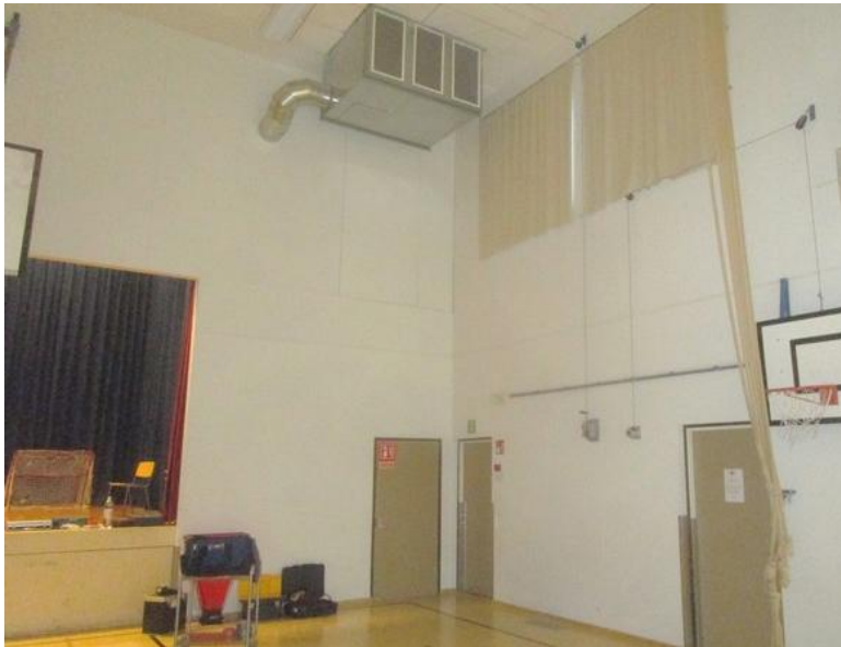
Kuva 9. Poistoilmalaitteet ovat kattokulmauksessa näyttämön vieressä.
