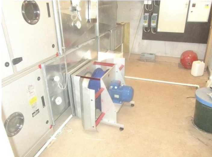
Kuva 3. IV-konehuone 209. Tuloilmakone TK2 on alempi kone vasemmalla.
