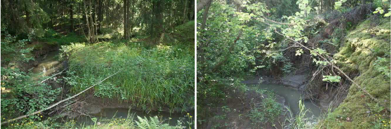
Kuva 50 a ja b. Sedimentaatio ja eroosio ovat uomassa voimakkaita. Hulevesien johtaminen puroon heikentää uoman luonnollista stabiiliteettia.
