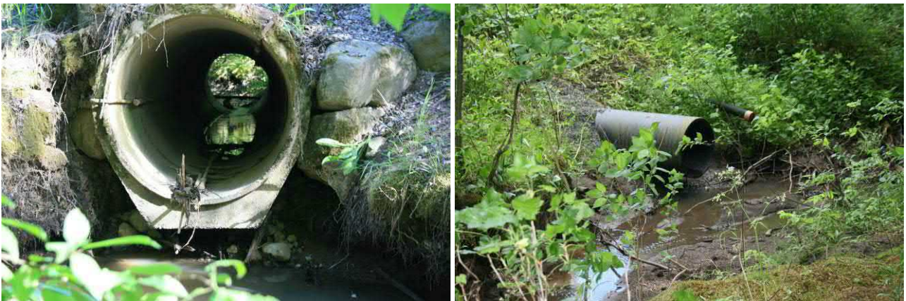
Kuva 49 a. Pyydyskorventien alittava rumpu on syöpynyt ja pidättää ylävirran puolella sedimenttiä. b. Uoman yläosalle johdetaan hulevesiä.
