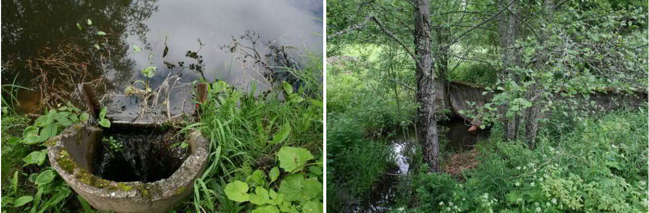
Kuva 44 a ja b. Vesirakenteet ovat elinkaarensa loppuvaiheessa.
