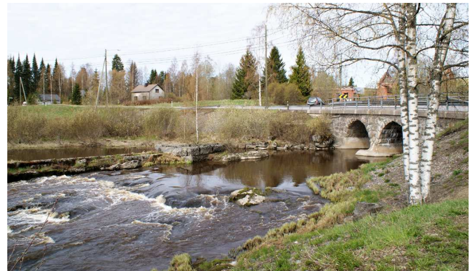
Kuva: Maantie ylittää kosken kaksiaukkoista kivisilta pitkin. Koskessa on säilynyt muurattuja kivirakenteita.
