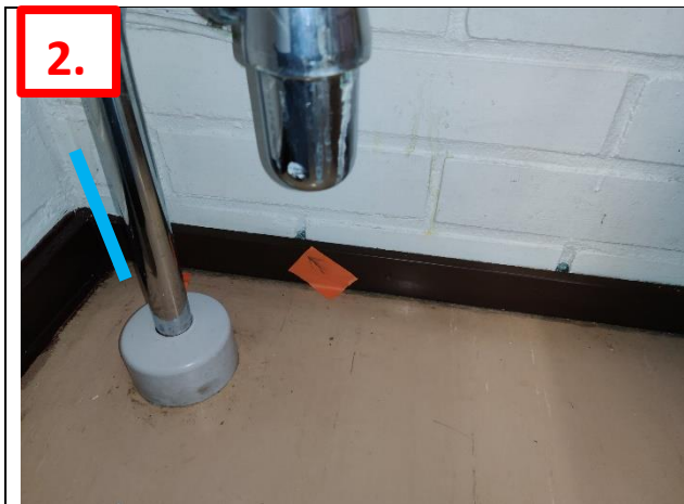
Kuva 4. Vuotokohta 2. Sinisellä viivalla on merkattu tiivistyksen raja.
