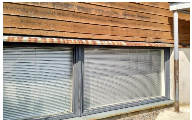
Kuva 51: Paneeliverhouksen alareunan pellityksessä esiintyy korroosiota.
