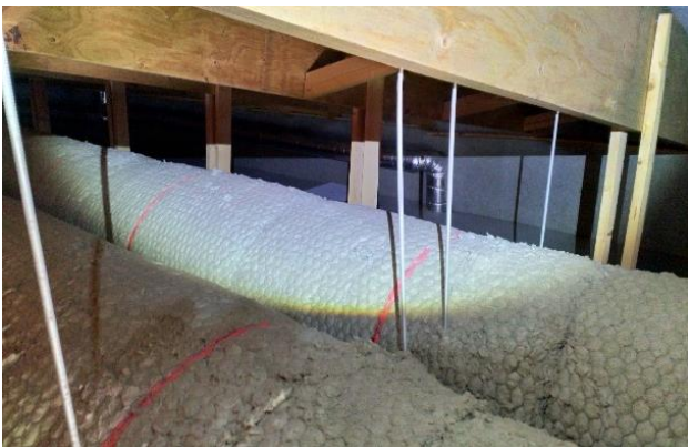
Kuva 65: Yläpohjan lvi-putket on lämmöneristetty.
