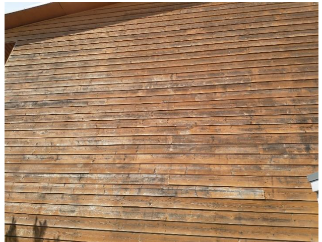
Kuva 49: Paneloinnin pintakäsittely on kulunut.
