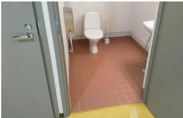
Kuva 74: WC-tilojen laatoituksissa oli näkyvissä normaalin kulumisen merkkejä.
