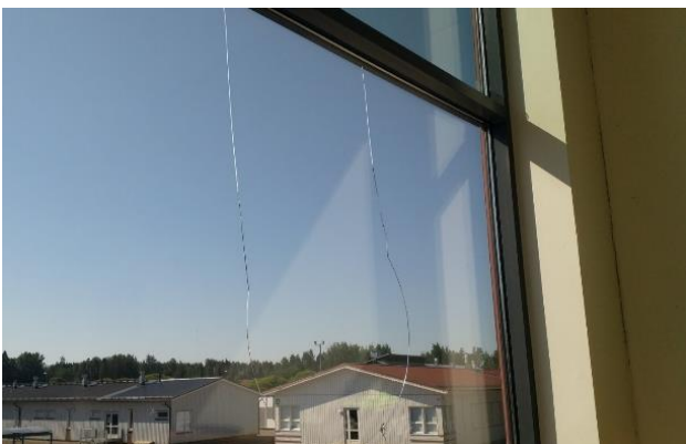
Kuva 54: Käytävän 181 korkeassa ikkunasissa on kahdessa kohdassa halkeamia.
