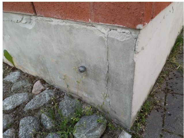
Kuva 20: Koillisnurkan sokkelissa esiintyy halkeamia ja betonin lohkeamista.
