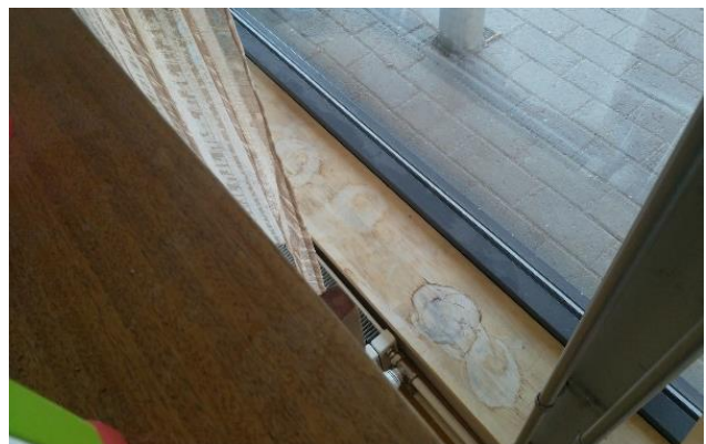
Kuva 55: Opetustilan 169 ikkunapenkissä kosteusvauriojälkiä. Jäljet oletettavasti peräisin kukkaruukuista tms.
