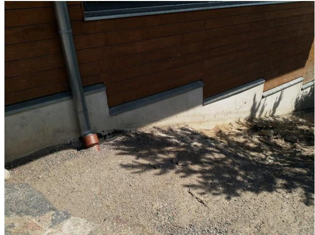
Kuva 9: Lounaispuolella syöksytorvi jatkettu suoraan sadevesiputkeen.
