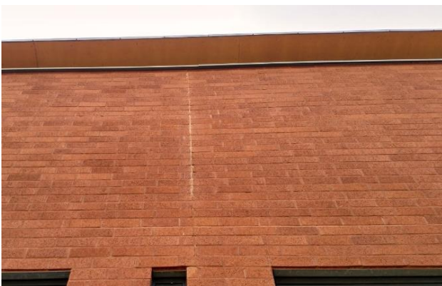
Kuva 50: Tiiliverhouksen liikuntasauaman tiivistys on alkanut halkeilla.
