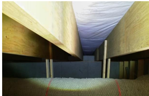
Kuva 66: Kantavissa palkeissa ei ollut merkkejä kosteusvaurioista. Yläpohjassa ei ollut myöskään viitteitä tuuletuksen puutteesta.
