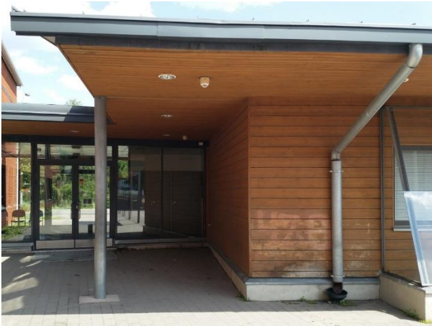
Kuva 8: Laajennusosan sadevedet ohjataan sadevesikourujen ja syöksytorvien kautta sadevesikaivoihin. Rakennuksen luoteisnurkalla syöksytorvi on kastellut ulkoseinän panelointia.
