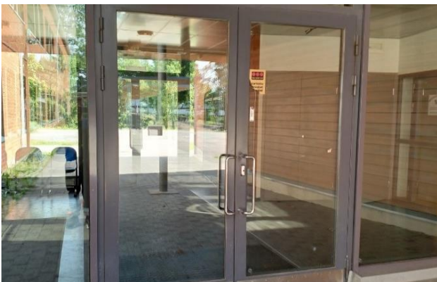
Kuva 52: Ulko-ovissa esiintyy paikoin maalin hilseilyä.
