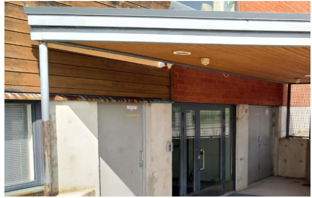
Kuva 58: Eteläpäädyn katoksen teräspilareissa esiintyy korroosiota.
