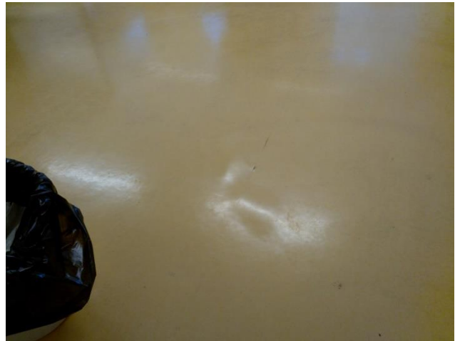
Kuva 37: Yksittäisiä lattiapäällysteen kupruja oli havait- tavissa opetustiloissa 170 ja 169
