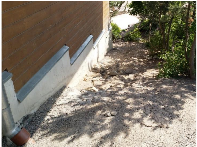
Kuva 3: Maata vyörynyt sateen mukana rakennuksen lounaissivulla.
