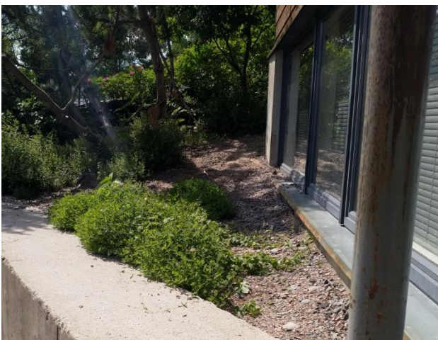
Kuva 4: Laajennusosan eteläpäädyssä maanpinta ulottuu osin ikkunan alareunaan päälle.
