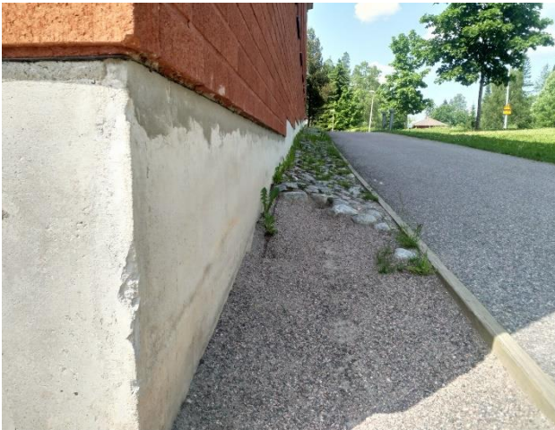
Kuva 2: Maanpinta rakennuksen vierellä viettää rakennuksesta pois-pään. Alarinteen puolella osa vieruskivistä on irronnut.
