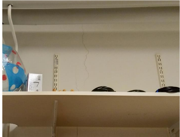
Kuva 17: Maanvastaisissa seinissä todettiin yksittäisiä pieniä halkeamia, joista voi vuotaa ilmaa rakennuksen sisälle. Halkeamat todettiin musiikkiluokassa 008 ja sen viereisessä varastossa 009.
