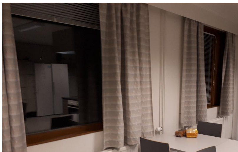
Kuva 17,18: Laajennusosan ikkunat ja ulko-ovet ovat tyydyttävässä kunnossa. Väliovet olivat hyvässä kunnossa.
