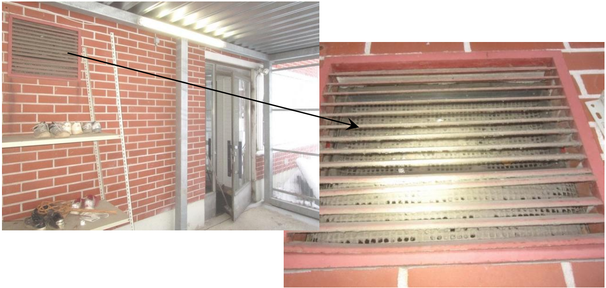
Kuvat 28 ja 29. Tuloilmakone TK01. Ulkoilmasäleikköön on kertynyt erittäin paljon epäpuhtauksia. Säleikkö sijaitsee ulkoseinällä rakennusosien välisessä katoksessa.
