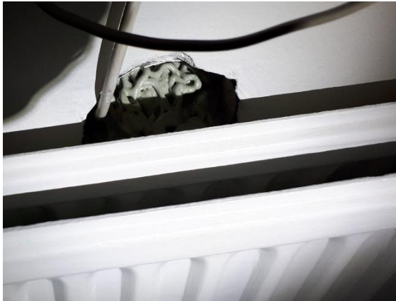
Kuva 7: Miehistön valmiuhuoneen huolimattomasti paikattu tuloilmaventtiilin aukko ulkoseinässä lämpöpatterin takana.
