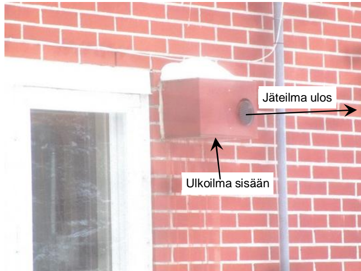
Kuva 24. Ilmanvaihtokone Parmair Ex. Ulkoilmasäleikkö sijaitsee ulkoseinällä jäteilmasäleikön lähellä.
