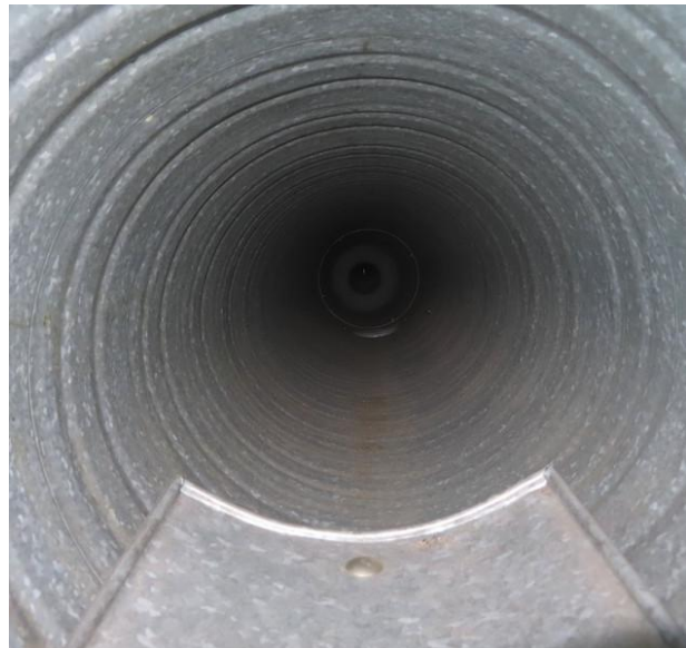
Kuva 24. Näytteenottopiste KP2, IV-koneen 4TK1 tuloilmakanava käytävällä 143.
