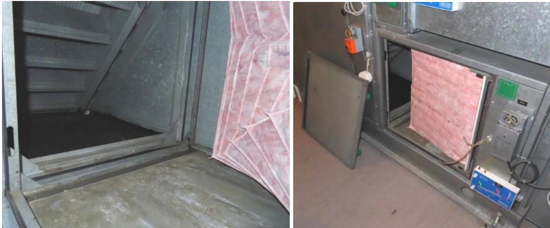
Kuvat 18 ja 19. Tuloilmasuodatin oli F7-tasoinen, suodatinkehys oli tiivis. Suodatinosan pohjalla oli kuivuneita kosteusjälkiä. Konekotelon sisäpintojen pölyn määrä oli vähäinen tuloilmasuodattimen jälkeen, sisäpinnoilla ei ollut mineraalivillaa.
