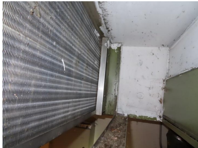
Kuva 14. Lämmityspatterissa oli jonkin verran hyönteisjäämiä.
