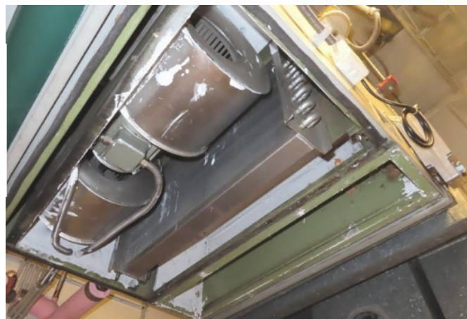
Kuva 15. Tuloilmapuhaltimet ovat suorakäyttöisiä (ei hihnoja). Konekotelon sisäpintojen pölyn määrä oli melko vähäinen tuloilmasuodattimen jälkeen. Sisäpintojen äänenvaimennusmateriaali oli pinnoitettu.
