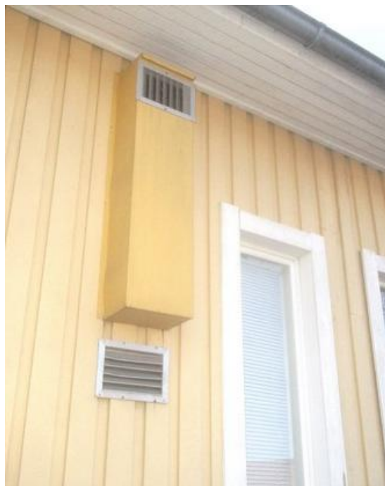
Kuva 8. Ulkoilmasäleikkö on räystäään alla. Alempana on jäteilmasäleikkö, josta puhallus on alas.
