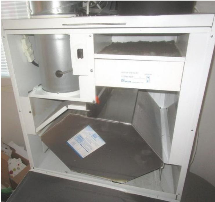
Kuva 9. Tuloilmapuolella oli esisuodattimena G4-tasoinen suodatinmatto ja suodattimena F7-tasoinen kadettisuodatin. Poistoilmasuodattimena oli G4-tasoinen suodatinmatto. Koneessa on levylämmöntalteenottolaite. Tuloilman suodatuksen jälkeen sisäpinoilla oli jonkin verran pölyä ja hyönteisjäämiä.
