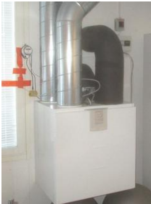
Kuva 7. Lisärakennuksen opetustilan P03 tilakohtainen Vallox-ilmanvaihtokone.
