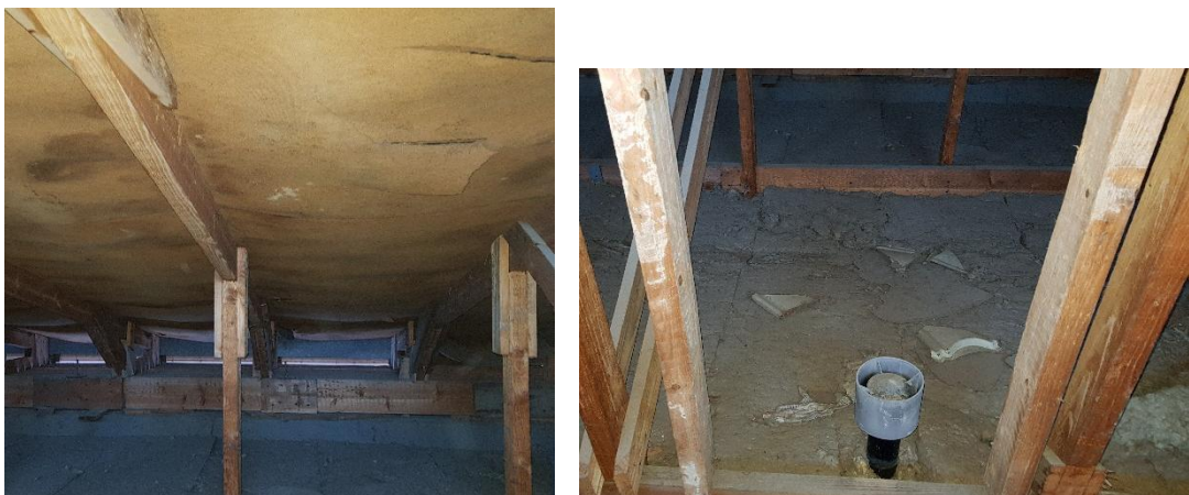
Kuva 1-2: Yläpohjarakenteen pahvissa oli nähtävillä kosteusvauriojälkiä. Eristeen päällä oli roskia.
