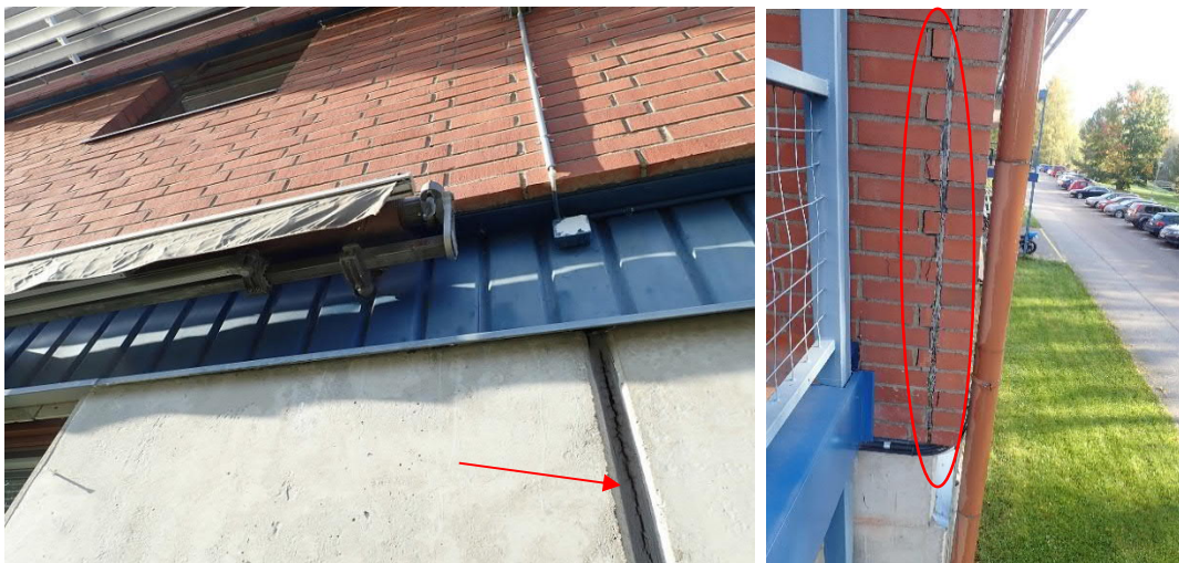
Kuva 1. Julkisivussa olevien halkeamien kautta rakenteeseen voi päästä kosteutta.
