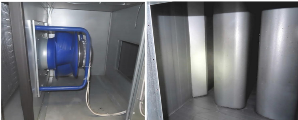
Kuva 8. Konekotelon sisäpintojen pölyn määrä oli vähäinen, sisäpinnoilla ei näy mineraalivillaa. Vasemmalla näkyvä tuloilmapuhallin on uusittu suoraikäyttöiseksi puhaltimeksi. Tuloilmapuhaltimen jälkeisessä oikealla näkyvässä äänenvaimentimessa ei näy mineraalivillaa.
