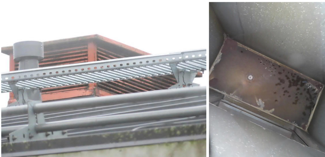
Kuva 6. Ulkoilmasäleikkö sijaitsee vesikatolla. Säleikössä ei ole erillistä lumi-/ sadesuojaa. Ulkoilmakammio on varustettu lattiakaivolla, josta menee veden poistoputki IV-konehuoneen lattiakaivoon. Kammiossa ei näy mineraalivillaa.
