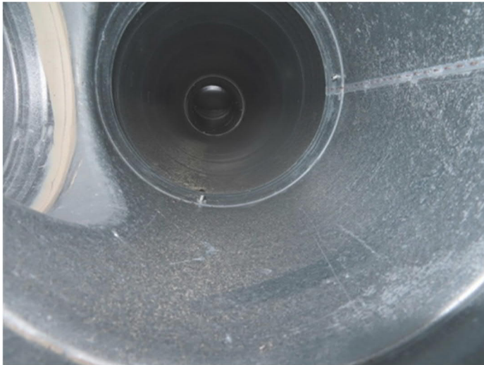
Kuva 12. Arviointipiste KP4, tuloilmakanava käytävällä 1074, sisäpinnan pölykertymäarvio 1-2 g/m 2 .
