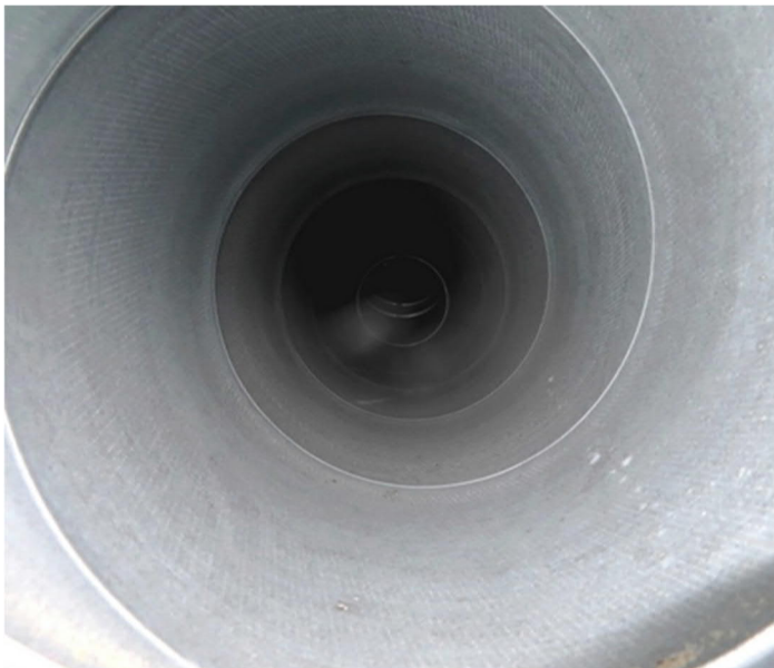
Kuva 11. Arviointipiste KP3, tilan 1113 tuloilmakanava, sisäpinnan pölykertymäarvio alle 1 g/m 2 .
