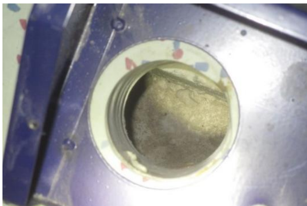
Kuva 13. Arviointipiste KP3, tuloilmakanava auditoriossa 107. Tuloilmakanava on rakenneaineinen, pölykertymä oli melko vähäinen.
