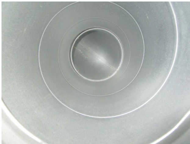
Kuva 11. Arviointipiste KP1, tuloilmakanava opetustilassa 114c. Sisäpinnan pölykertymäarvio alle 1 g/m 2 . Pöly ei kasaantunut sormella pyyhittäessä.
