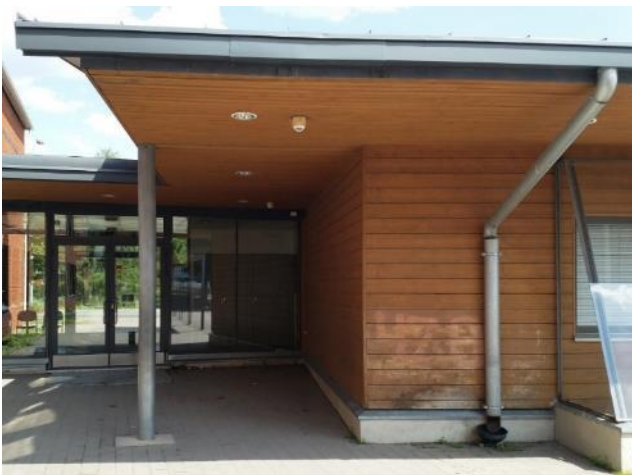
Kuva 11: Laajennusosan sadevedet ohjataan sadevesikourujen ja syöksytorvien kautta sadevesikaivoihin. Rakennuksen luoteisnurkalla syöksytorvi on kastellut ulkoseinän panelointia.
