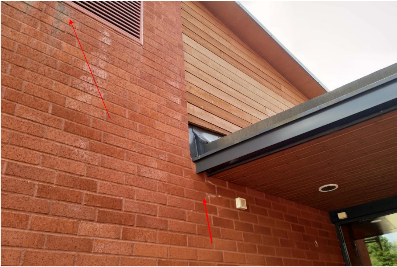
Kuva 68. Ulkoilmakammion edustalla ja katoksen ränninkourun alapuolella on veden valumajälkiä.
