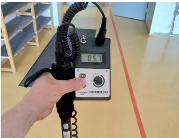
Kuva 49: Välipohjan pintakosteuslukemat olivat paikoin hieman koholla.
