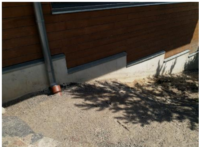
Kuva 12: Lounaispuolella syöksytorvi jatkettu suoraan sadevesiputkeen.
