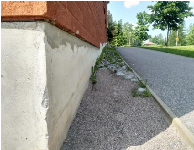
Kuva 2: Maanpinta rakennuksen vierellä viettää rakennuksesta pois-pään. Alarinteen puolella osa vieruskivistä on irronnut.
