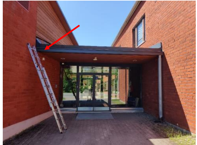
Kuva 14. Yhdyskäytävän rännikourusta puuttuu kaato. Kosteusjälkiä seinällä nuolen osoittamassa paikassa.
