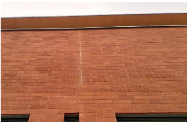
Kuva 64: Tiiliverhouksen liikuntasauaman tiivistys on alkanut halkeilla.
