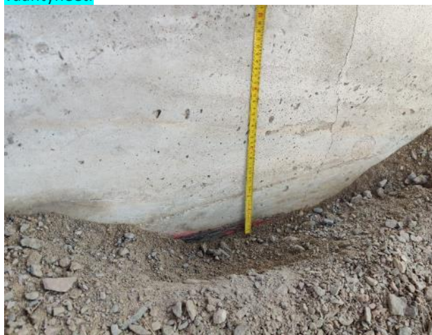
Kuva 30. Länsipuolella rakennusta patolevy oli noin 200 mm maanpinnan alapuolella.
