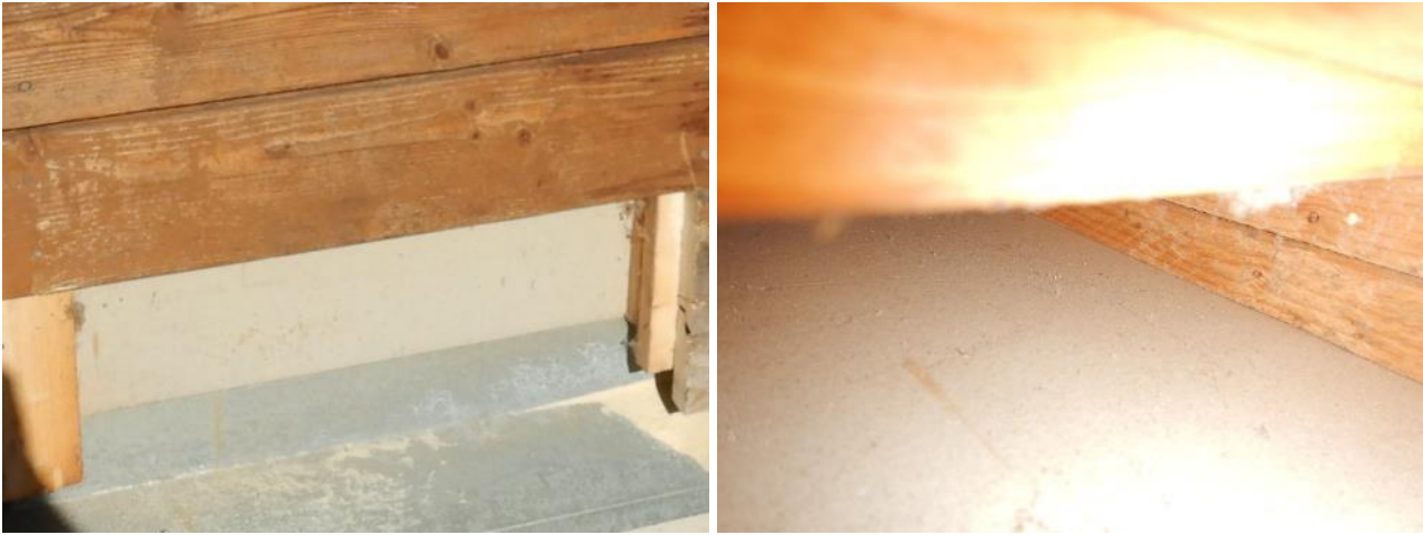
Kuva 66. Paneelin takana ei ollut merkkejä kosteusvaurioista tuulensuojalevyssä
