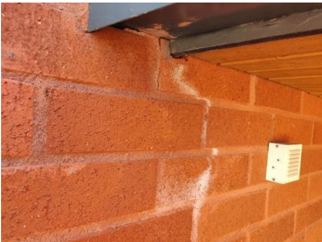
Kuva 15. Rännikourun päässä tiiliseinällä on kosteusjälkiä. Rännikouru ohjaa vesiä seinään.
