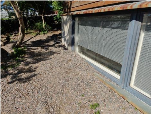
Kuva 4: Laajennusosan eteläpäädyssä maanpinta ulottuu osin ikkunan alareunan päälle.
