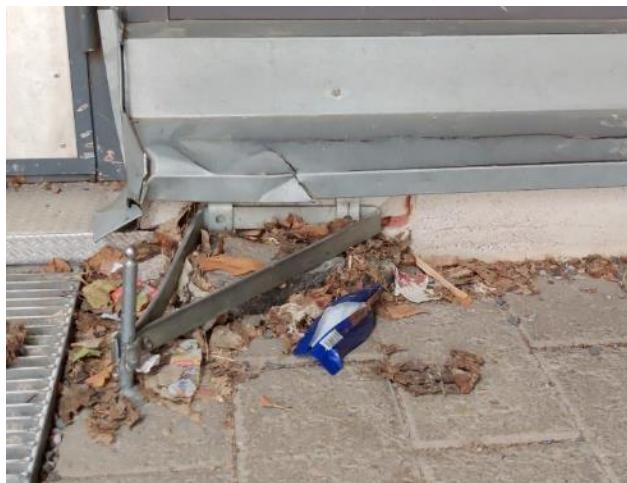
Kuva 28. Yhdyskäytävän sokkeli- ja vesipellitykset ovat vääntyneet.
