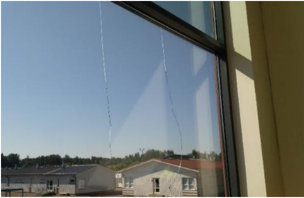
Kuva 75: Käytävän 181 korkeassa ikkunassa on kahdessa kohdassa halkeamia.
