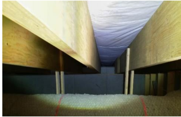
Kuva 89: Kantavissa palkeissa ei ollut merkkejä kosteusvaurioista. Yläpohjassa ei ollut myöskään viitteitä tuuletuksen puutteesta.
