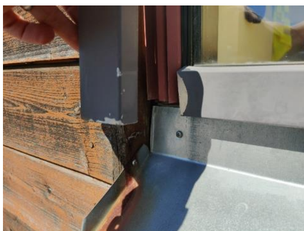
Kuva 72: Käytävän 181 päätyikkunan pellitusten reunoja ei oltu tiivistetty.
