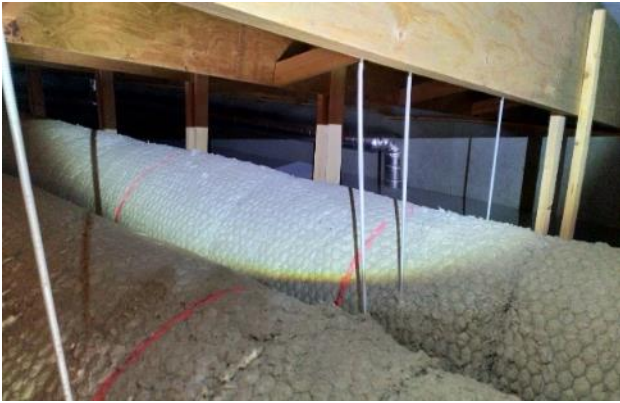
Kuva 88: Yläpohjan lvi-putket on lämmöneristetty.
