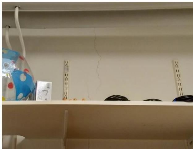
Kuva 23: Maanvastaisissa seinissä todettiin yksittäisiä pieniä halkeamia, joista voi vuotaa ilmaa rakennuksen sisälle. Halkeamat todettiin musiikkiluokassa 008 ja sen viereisessä varastossa 009.
