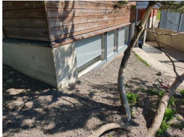
Kuva 5: Eteläpäädyssä maanvastaisen seinän ja tukimuurin väliin jää kaukalo, jonka vedenpoisto ei toimi.
