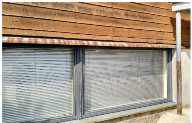
Kuva 65: Paneeliverhouksen alareunan pellityksessä esiintyy korroosiota.
