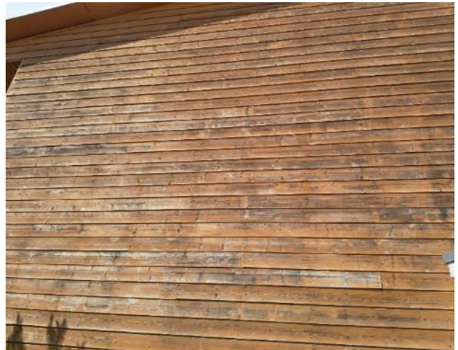
Kuva 63: Paneloinnin pintakäsittely on kulunut.
