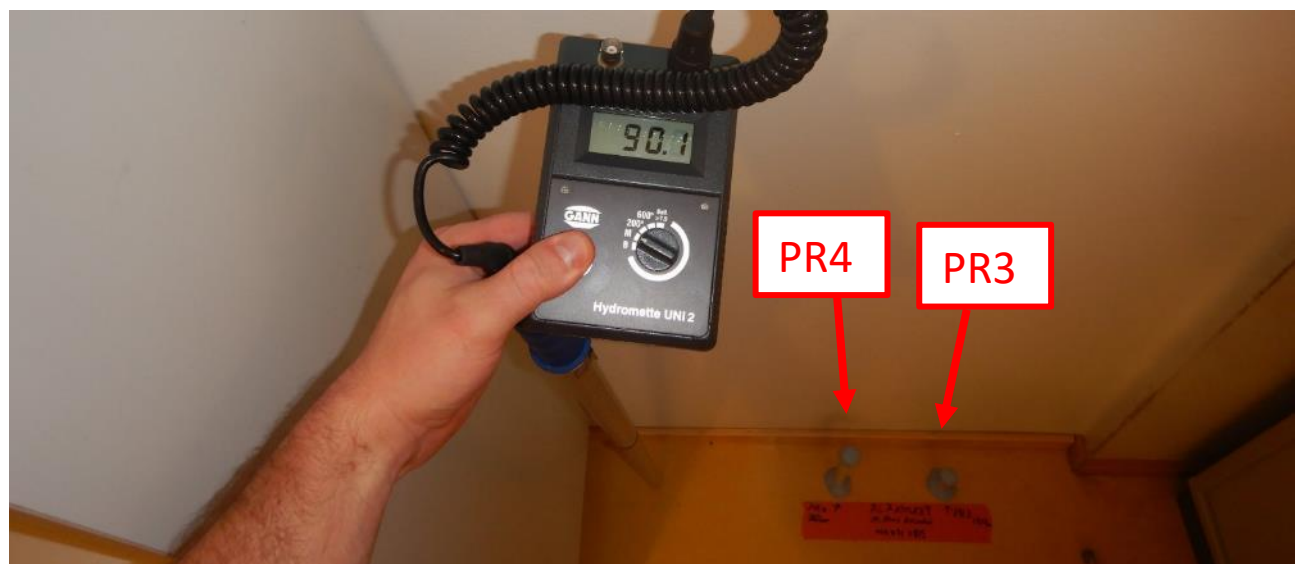
Kuva 52. Porareikäkosteusmittauksien PR3 ja PR4 sijainnit sekä kohdan pintakosteusarvo.
