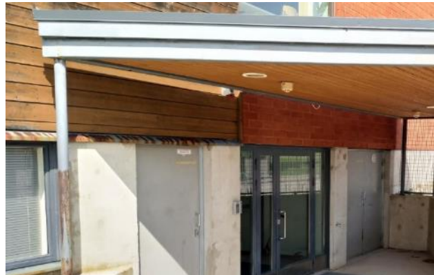
Kuva 79: Eteläpäädyn katoksen teräspilareissa esiintyy korroosiota.
