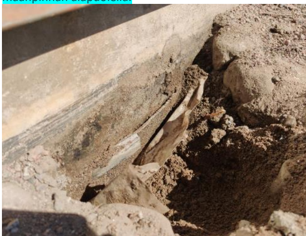
Kuva 31. Musiikinluokan 008 edustalla sokkelin/ maanvastaisen seinän vedeneristeenä oli bitumikermi. Kermi oli noin 150 mm maanpinnan alapuolella.
