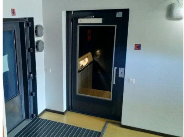
Kuva 55: Laajennusosalla on käytössä yksi hissi.
