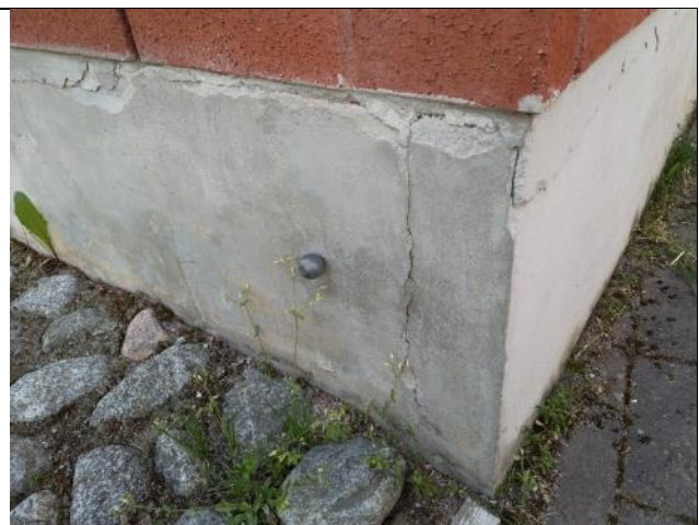
Kuva 26: Koillisnurkan sokkelissa esiintyy halkeamia ja betonin lohkeamista.
