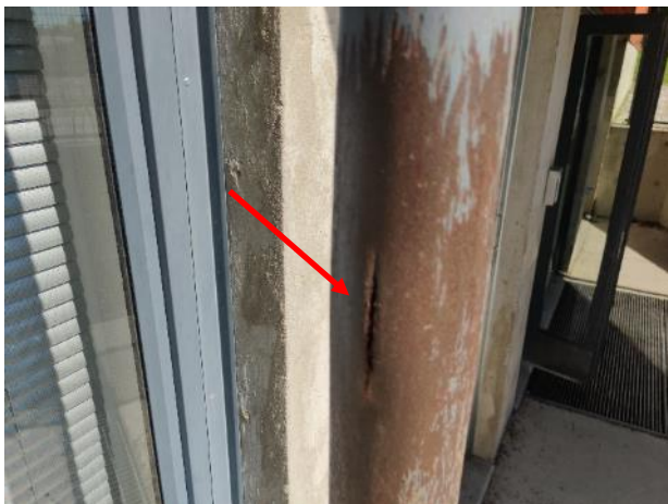
Kuva 80. Eteläpäädyn katoksen teräspilarissa on vakavaa korroosiota.
