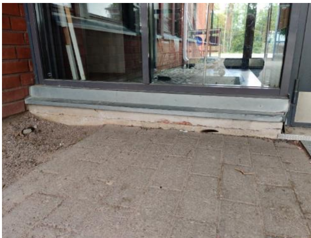
Kuva 27. Yhdyskäytävän sokkelissa on halkeamia.
