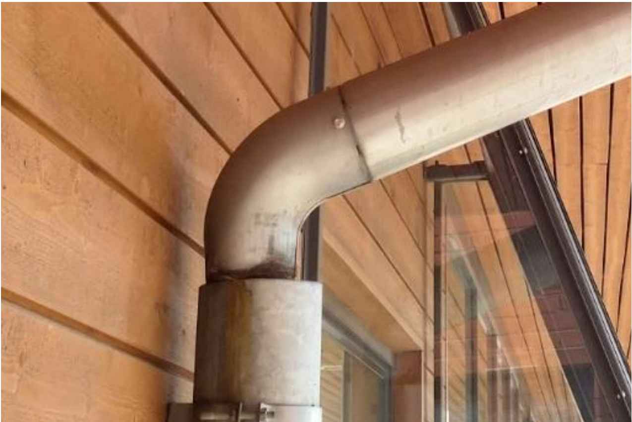
Kuva 97. Syöksytorven epätiiveyskohta merkattu punaisella nuolella.
