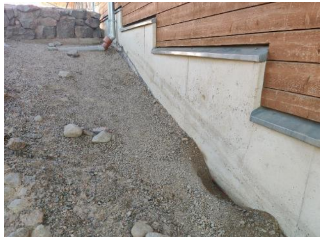
Kuva 3: Maata vyörynyt sateen mukana rakennuksen lounais-sivulla. Sokkelivierustoilla on hienoa hiekkaa, joten pystysalaojitus ei toimi.
