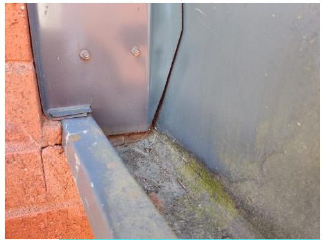
Kuva 16. Rännikouru ohjaa vesiä seinään. Vettä pääsee rännikourun päätylaipan epätiiveyksistä tiiliseinään.
