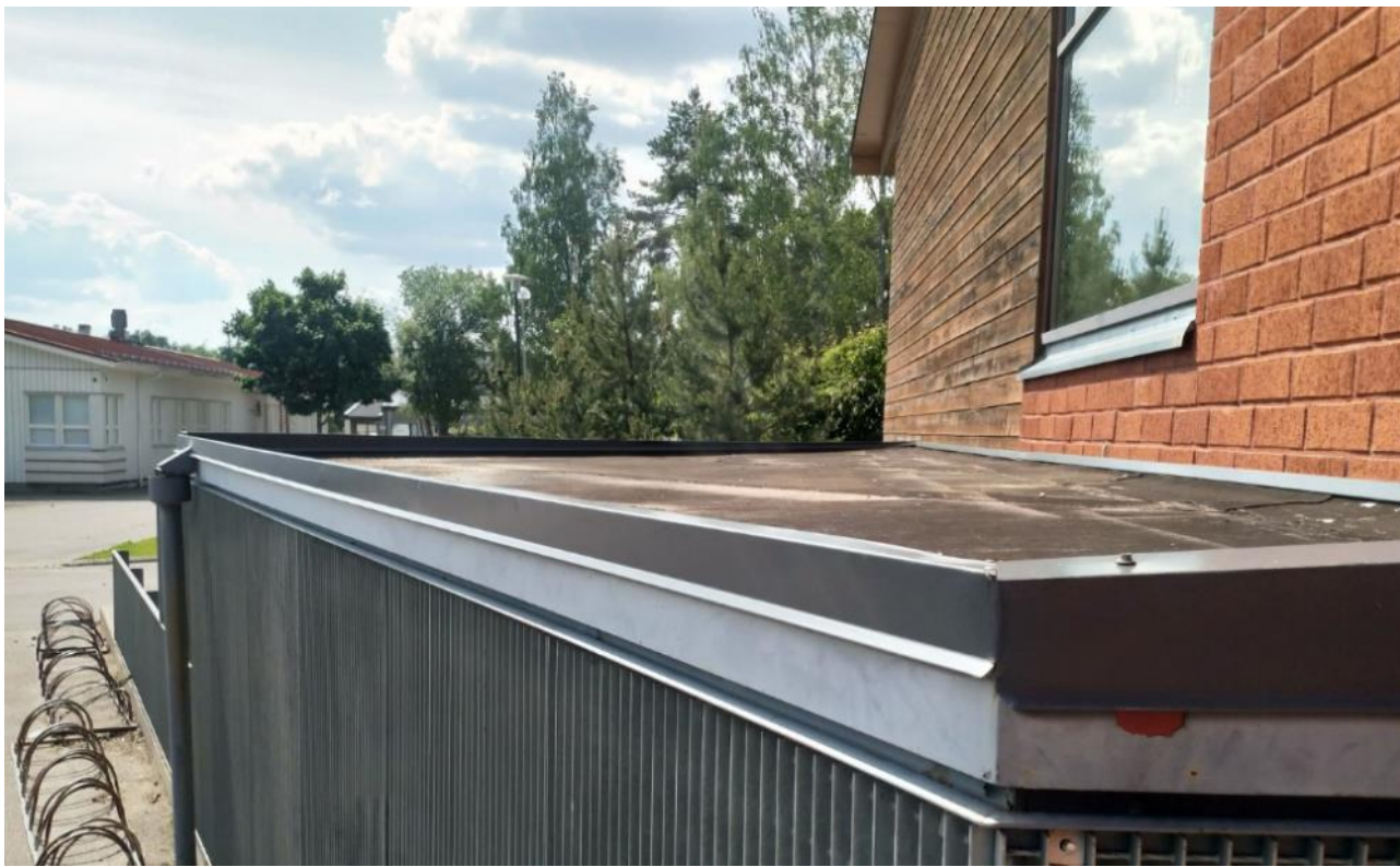
Kuva 81. Eteläpäädyn katoksen vesikermin ylös nosto ulkoseinällä ei ole suunnitteluohjeiden mukainen.
