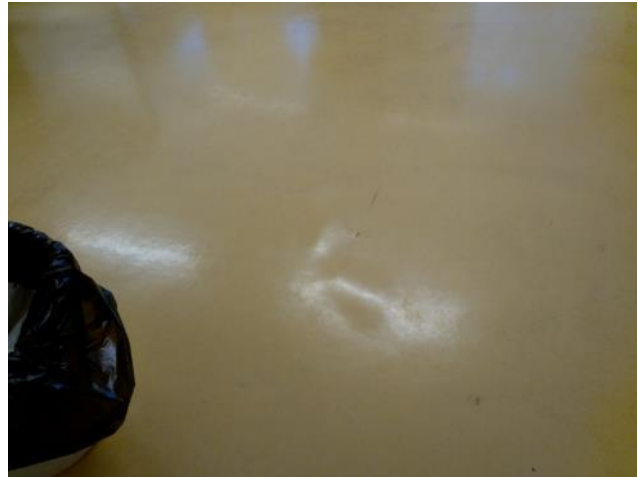
Kuva 48: Yksittäisiä lattiapäällysteen kupruja oli havaittavissa opetustiloissa 170 ja 169
