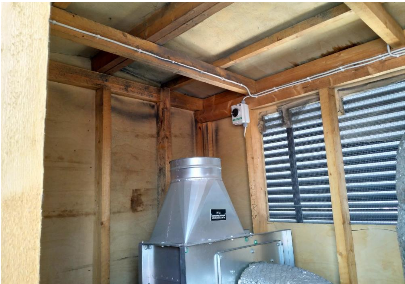
Kuva 90. Poistoilmatornin rakenteissa on kosteusvaurioita, koska poistoilmaa ei ole kanavoitu poistoilmasäleikölle.
