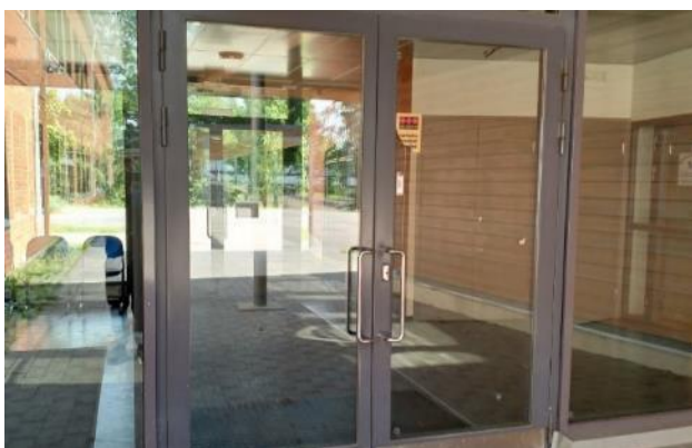
Kuva 73: Ulko-ovissa esiintyy paikoin maalin hilseilyä.
