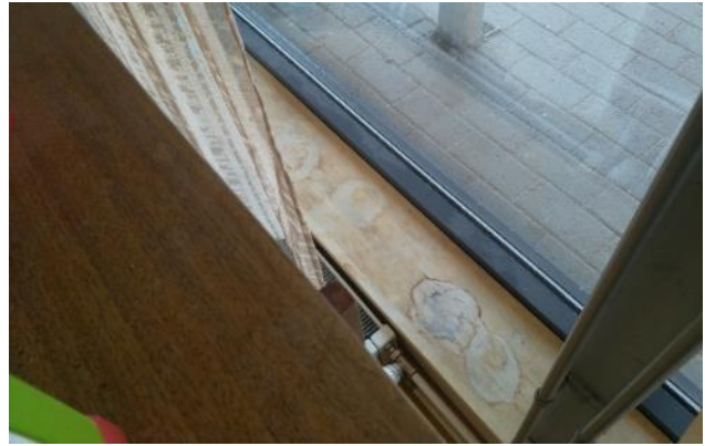
Kuva 76: Opetustilan 169 ikkunapenkissä kosteusvauriojälkiä. Jäljet oletettavasti peräisin kukkaruukuista tms.
