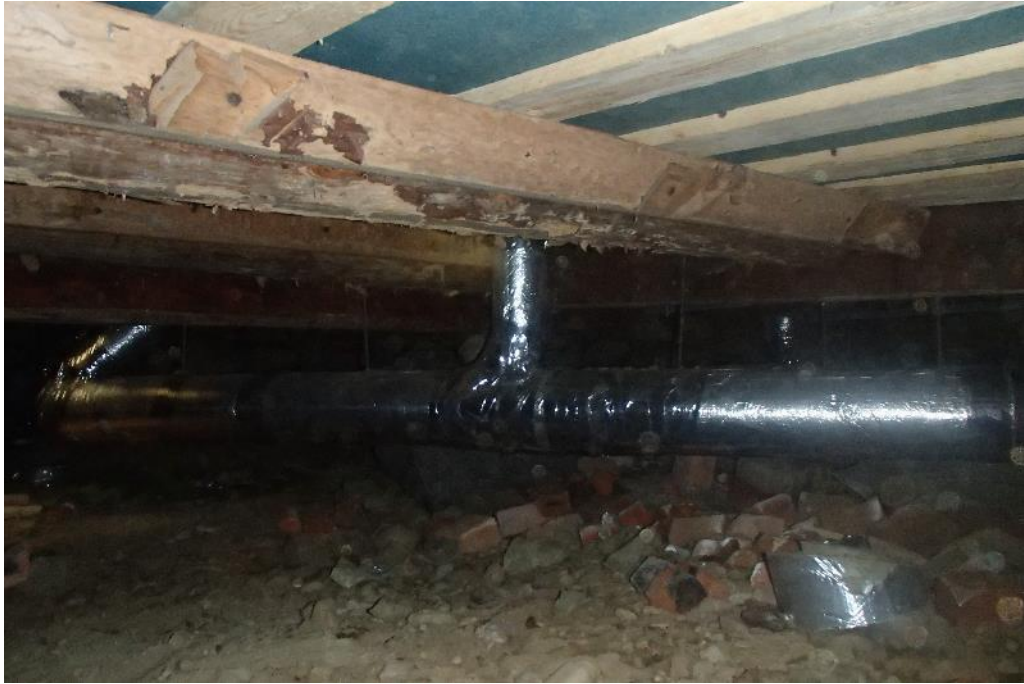
Kuva 21. Viemäriputket on eristetty ryömintätilan puolelta.
