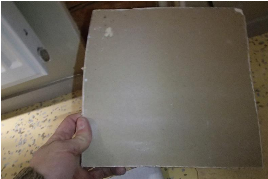
Kuva 72. Rakenneavausten yhteydessä ei havaittu kipsilevyjen pinoilla vaurioita.
