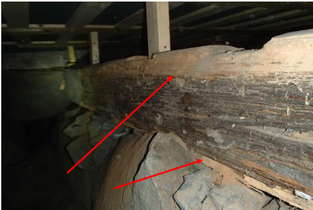
Kuva 16. Musiikkiluokan keskilinan kantavassa puupalkissa havaittiin laho- ja hyönteisvaurioita.
