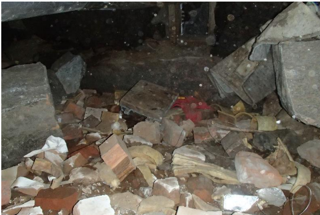
Kuva 24. Ryömintätilassa on jonkin verran ylimääräistä roskaa ja orgaanista materiaalia.
