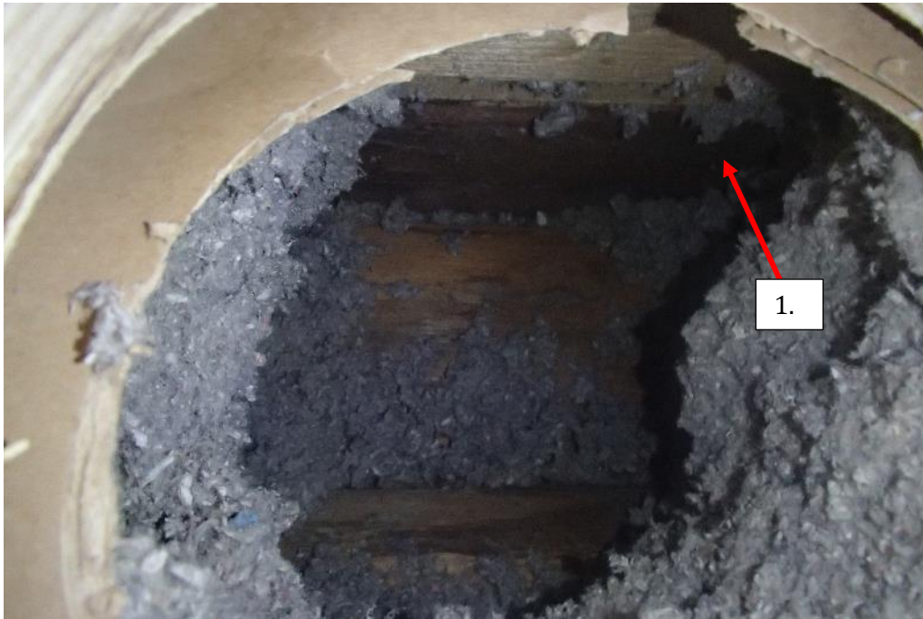
Kuva 4. Rakenneavaus, RAKA2, rehtorin huoneen alapohjaan terveydenhoitajan huoneen välisen väliseinän viereen. Kuvassa numero 1. kohdalla väliseinärakenteiden hirsirunko ja alapohjan puolella ei ole tuulensuojalevyä väliseinän vieressä.
