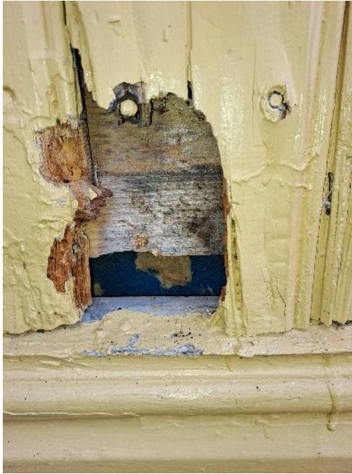
Kuva 67. Julkisivupaneloinnissa havaittiin paikallisia vaurioita.
