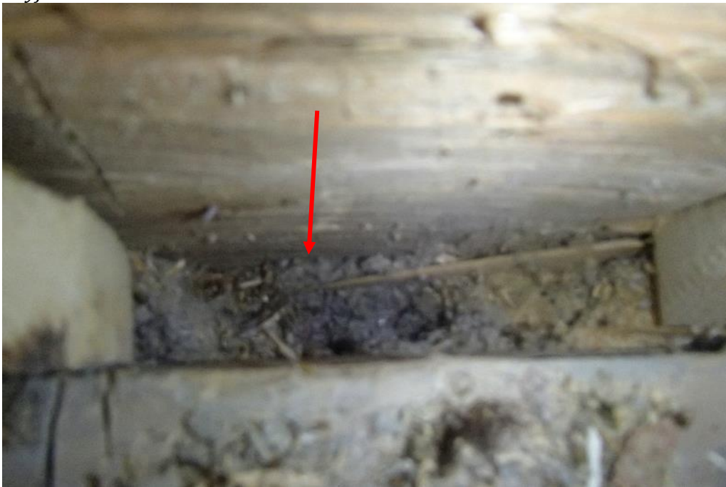
Kuva 82. Luokkahuoneen alapohjan ja hirsirungon rajapinnoilla havaittiin eristeet.
