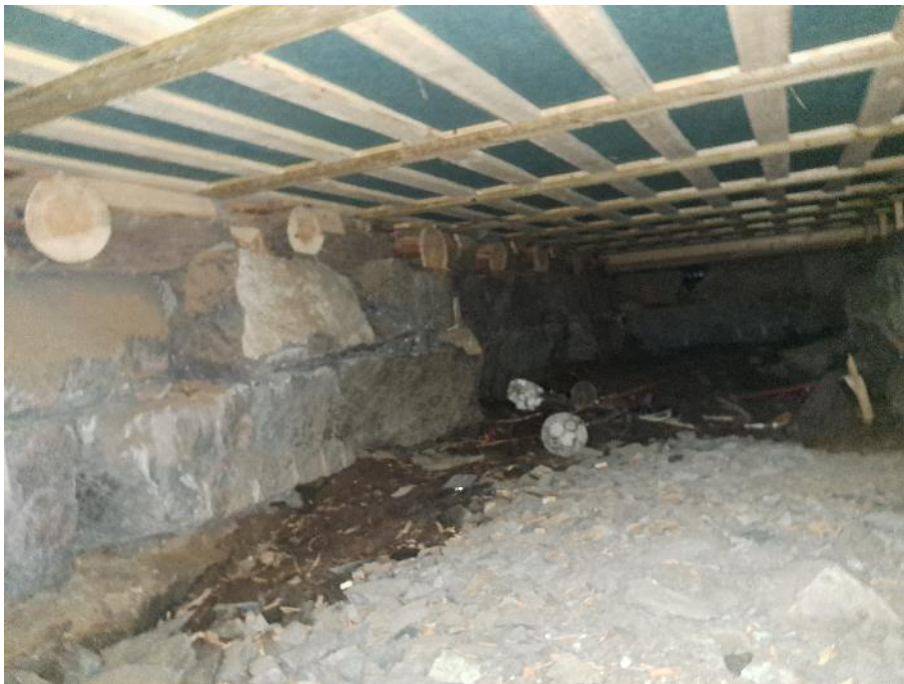
Kuva 30. Ryömintätilan maapinnat ovat kosteita pääosin sokkelin vierestä.
