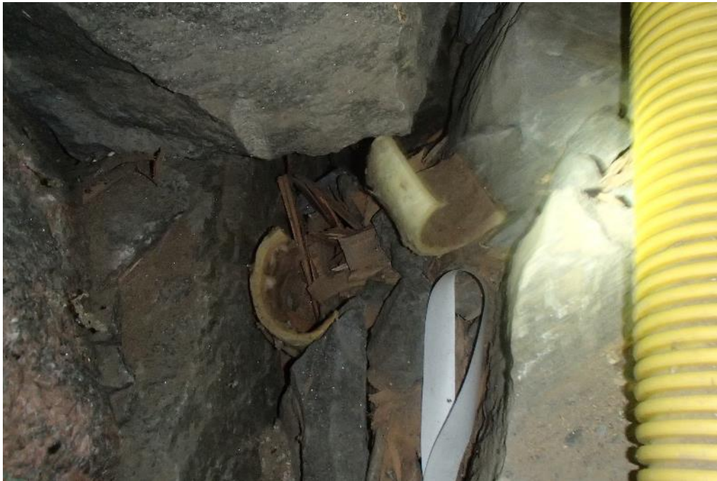
Kuva 25. Ryömintätilassa on jonkin verran ylimääräistä roskaa ja orgaanista materiaalia.
