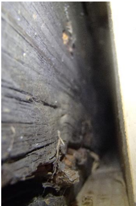
Kuva 68. Hirsirungon ulkopinnat ovat harmaantuneet ja hieman halkeilleet.
