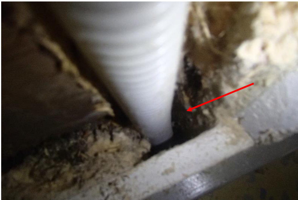
Kuva 76. Sähköputkien roiloista on suorat ilmayhteydet alapohjarakenteisiin ja pintaverhouslevyjen taustalla havaittiin ilmavirtauksia.
