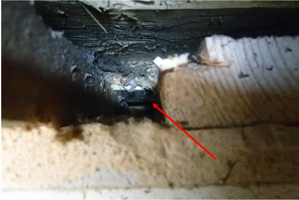
Kuva 79. Pintaverhouslevyjen ja laudoituksen taustan ilmaraossa havaittiin ilmapirtauksia ja ilmayhteyksiä alapohjarakenteisiin.
