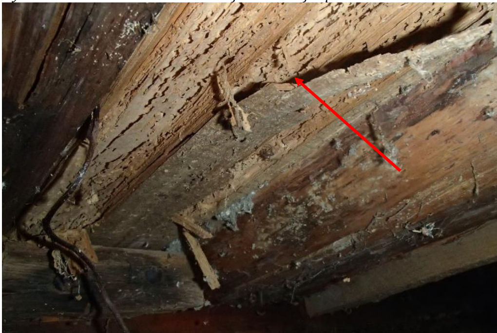
Kuva 14. Ryömintätilan puoleisissa vanhoissa alalautoituksissa havaittiin laho- ja hyönteisvaurioita.
