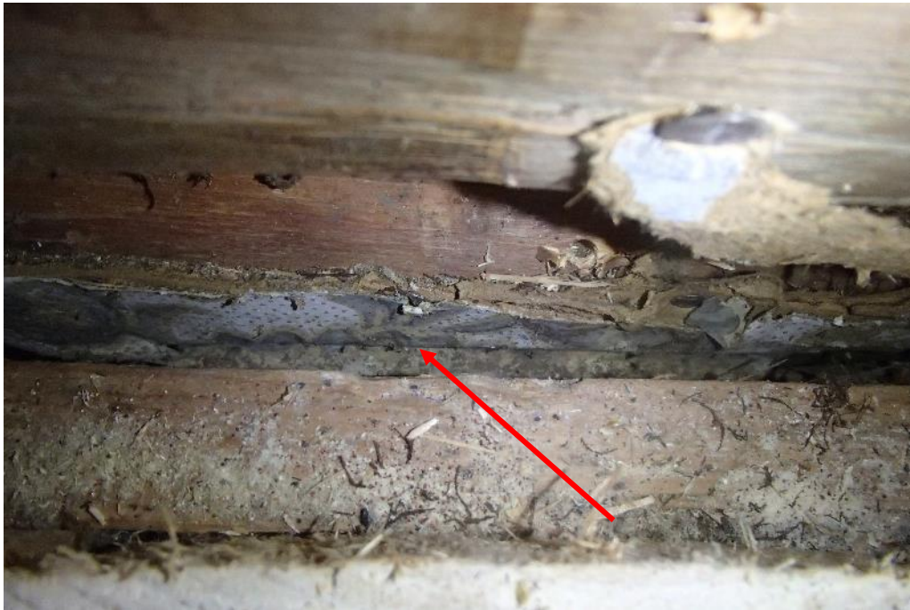
Kuva 75. Paikoin vanhoissa tapettipinnoilla havaittiin vanhoja kosteusjälkiä.
