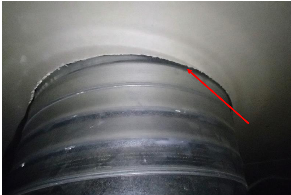
Kuva 52. Yläpohjan läpivientejä ei ole tiivistetty.
