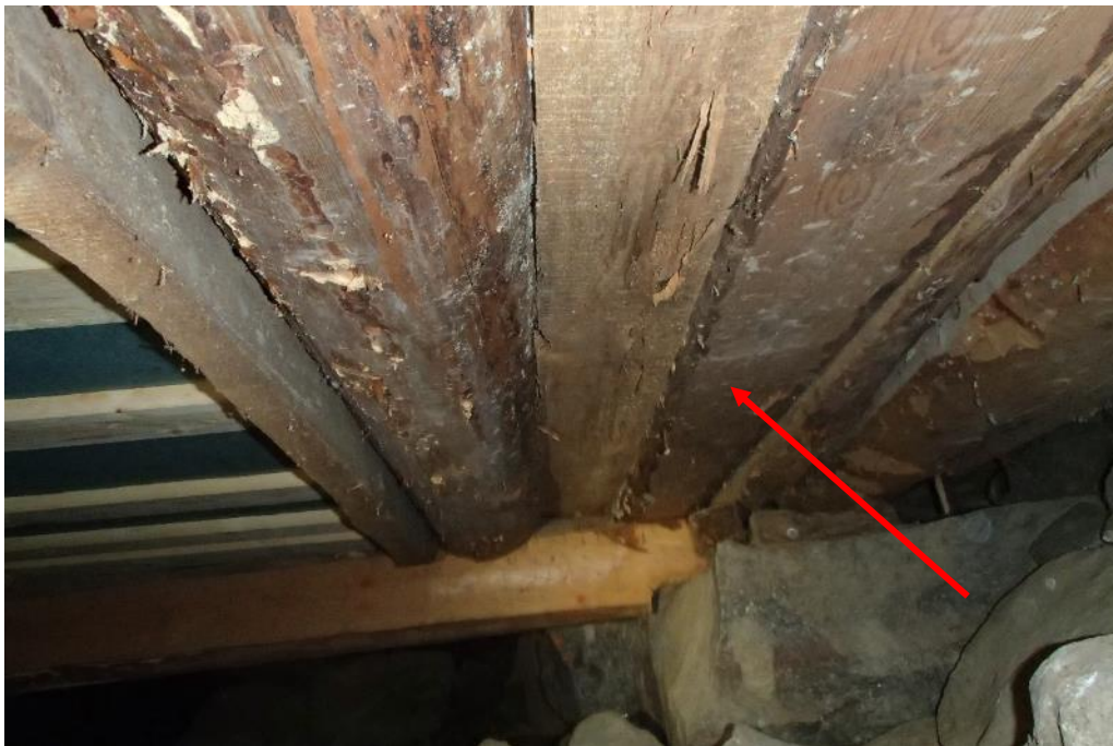
Kuva 12. Alapohjan ja väliseinien reuna-alueilla ei ole tuulensuojalevyä.
