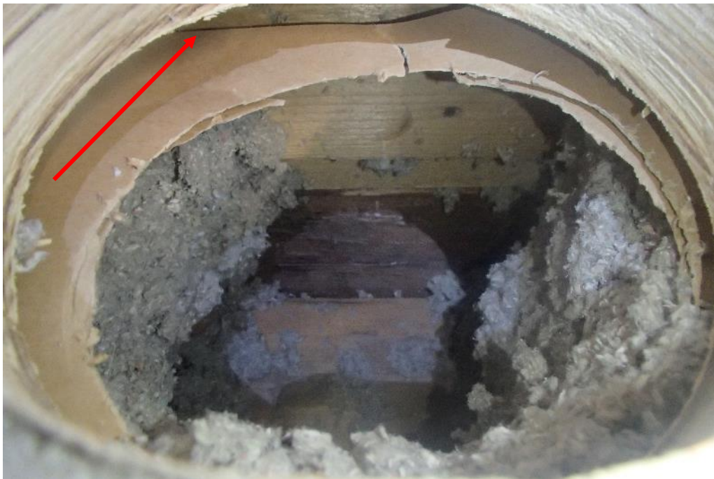
Kuva 10. Alapohjarakenteiden ilmasulkupaperia ei ole kiinnitetty seinärakenteisiin tiiviisti.
