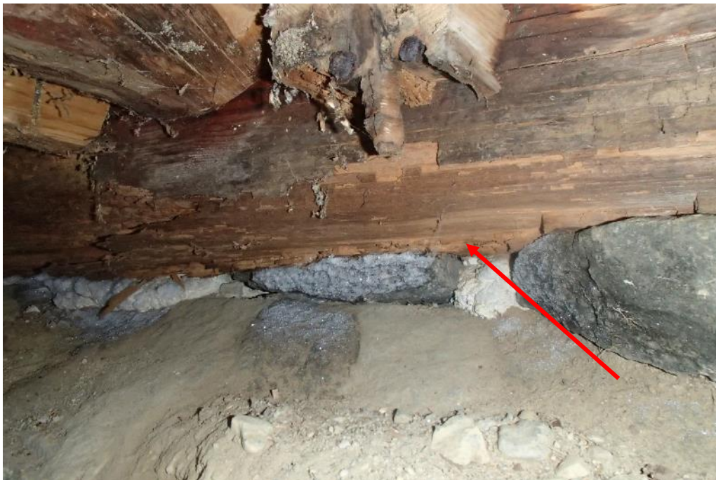
Kuva 20. Paikallisesti sokkelin rajapinnoilla havaittiin hirsirungossa laho- ja hyönteisvaurioita.
