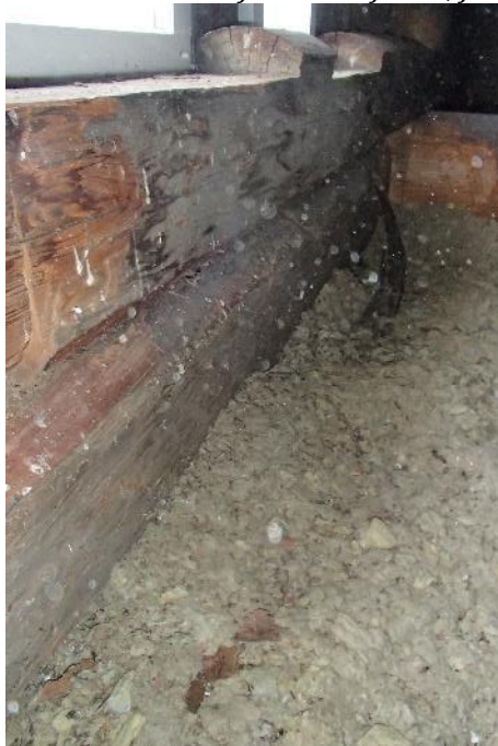
Kuva 51. Rakennuksen länsipäädyn ikkunan alapuolella on vanhoja kosteusjälkiä.
