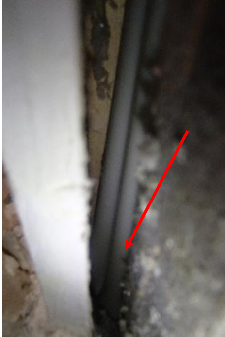
Kuva 81. Sähköputkien roiloista on suorat ilmayhteydet alapohjarakenteisiin ja pintaverhouslevyjen taustalla havaittiin ilmavirtauksia.
