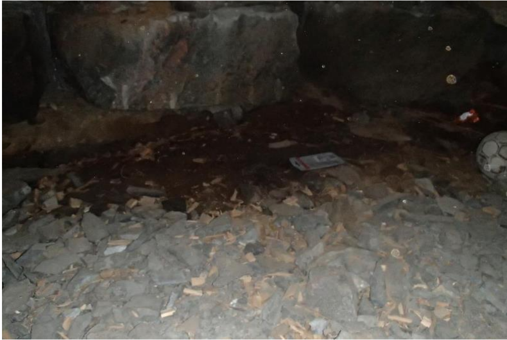
Kuva 29. Ryömintätilan maapinnat ovat kosteita pääosin sokkelin vierestä.
