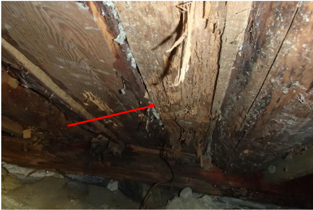
Kuva 15. Ryömintätilan puoleisissa vanhoissa alalautoituksissa havaittiin laho- ja hyönteisvaurioita.
