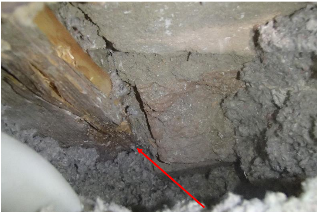
Kuva 84. Rehtorin huoneen ja terveydenhoitajan huoneen väliseinän puussa havaittiin lahovaurioihin viittaavia tekijöitä.
