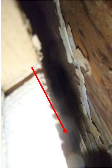
Kuva 77. Pintaverhouslevyjen ja laudoituksen taustan ilma-araossa havaittiin ilmvirtauksia ja ilmayhteyksiä alapohjarakenteisiin.
