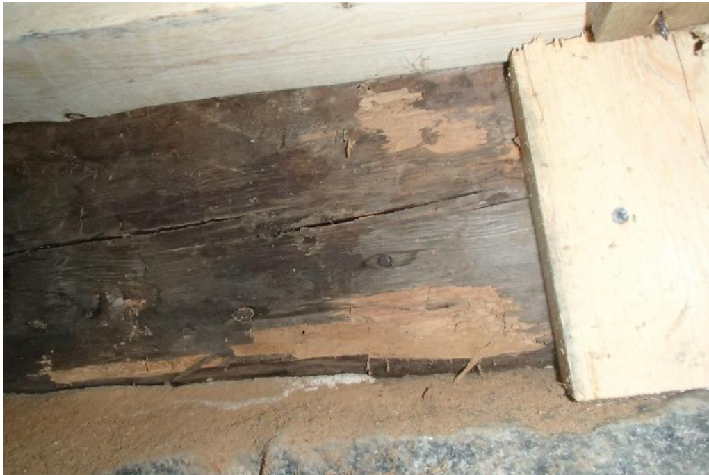
Kuva 19. Paikallisesti alapohjan kantavissa puupalkeissa havaittiin laho- ja hyönteisvaurioita.
