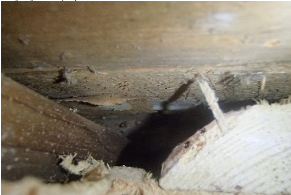
Kuva 78. Pintaverhouslevyjen ja laudoituksen taustan ilma-araossa havaittiin ilmvirtauksia ja ilmayhteyksiä alapohjarakenteisiin.
