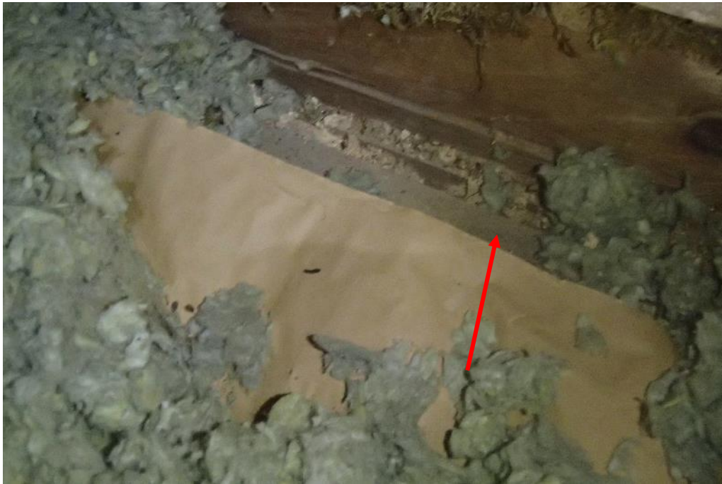
Kuva 48. Yläpohjarakenteiden ilmasulkupaperia ei ole asennettu tiiviisti.
