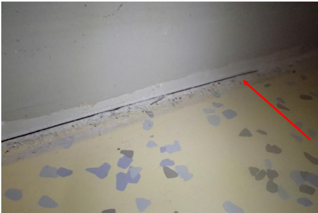
Kuva 8. Lattian ja seinän rajapintoja on tiivistetty liimamassalla, mutta tiivistykset ovat halkeilleet opettajien huoneessa.
