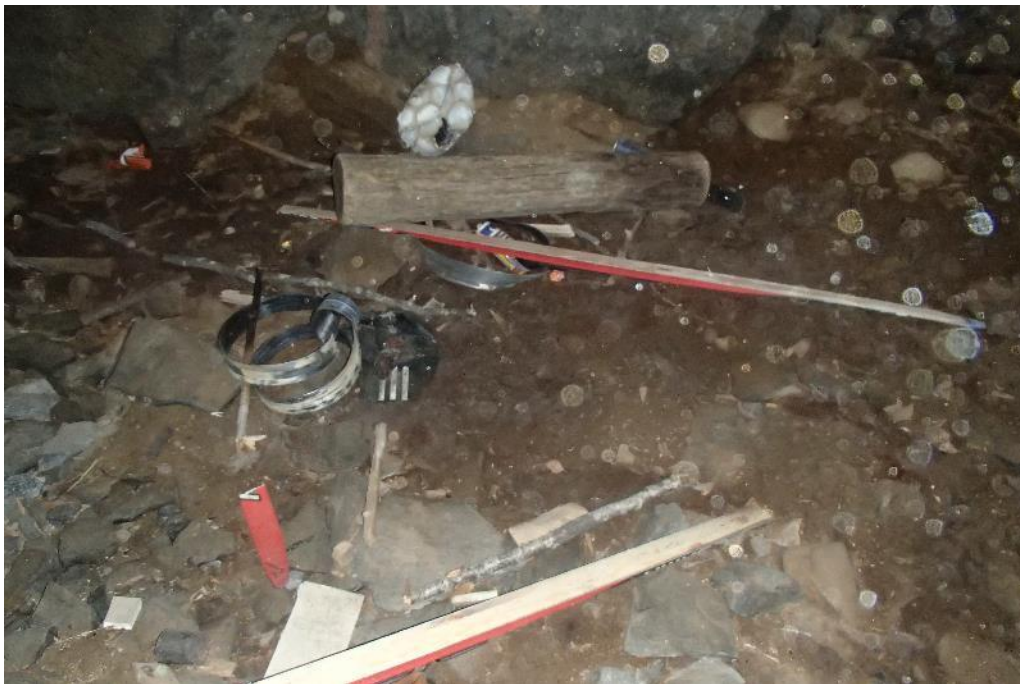
Kuva 26. Ryömintätilassa on jonkin verran ylimääräistä roskaa ja orgaanista materiaalia.
