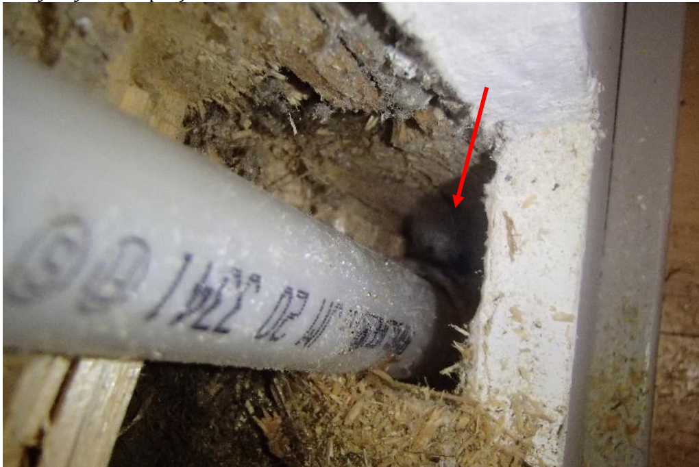
Kuva 80. Sähköputkien roiloista on suorat ilmayhteydet alapohjarakenteisiin ja pintaverhouslevyjen taustalla havaittiin ilmapirtauksia.
