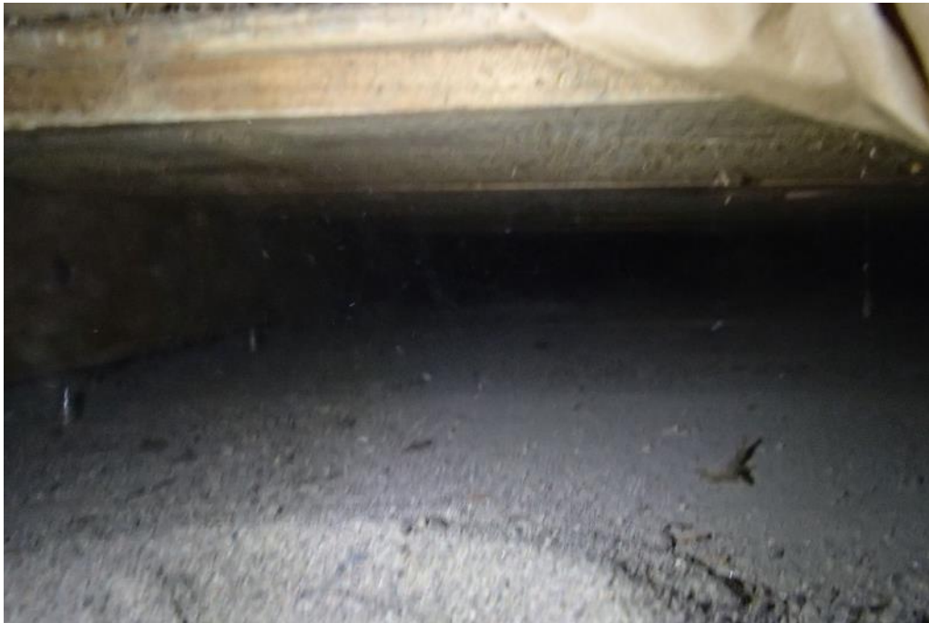
Kuva 47. Rakenneavaus, RAKY2, luokkahuoneen yläpuoleiseen yläpohjaan keskialueelta. Keski-alueella yläpohjassa oli puurunko ja ilmaväli eristeiden alapuoleisen laudoituksen alapuolella.
