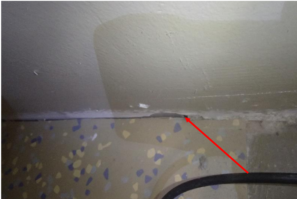
Kuva 9. Lattian ja seinän rajapintoja on tiivistetty liimamassalla, mutta tiivistykset ovat halkeilleet rehtorin huoneessa.
