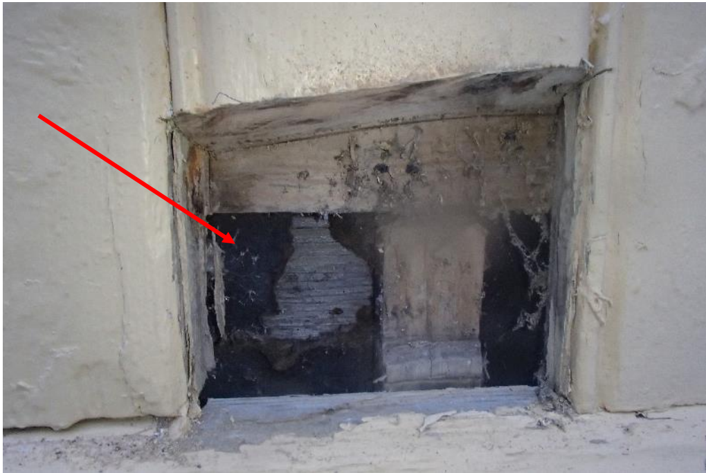
Kuva 71. Paikoin julkisivuverhouksen taustalla on tervapahvi.
