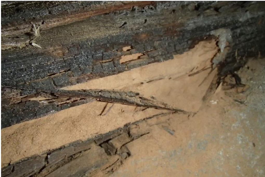
Kuva 18. Musiikkiluokan keskilinan kantavassa puupalkissa havaittiin laho- ja hyönteisvaurioita.
