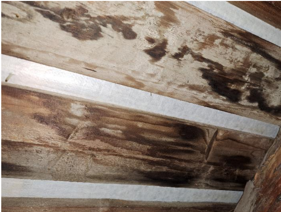
Kuva 50. Vanhojen harvalaudoitusten päälle on asennettu aluskate. Vanhoissa harvalaudoituksissa on vanhoja kosteusjälkiä, jotka ovat tyypillisiä tämän ikäluokan rakennuksessa.
