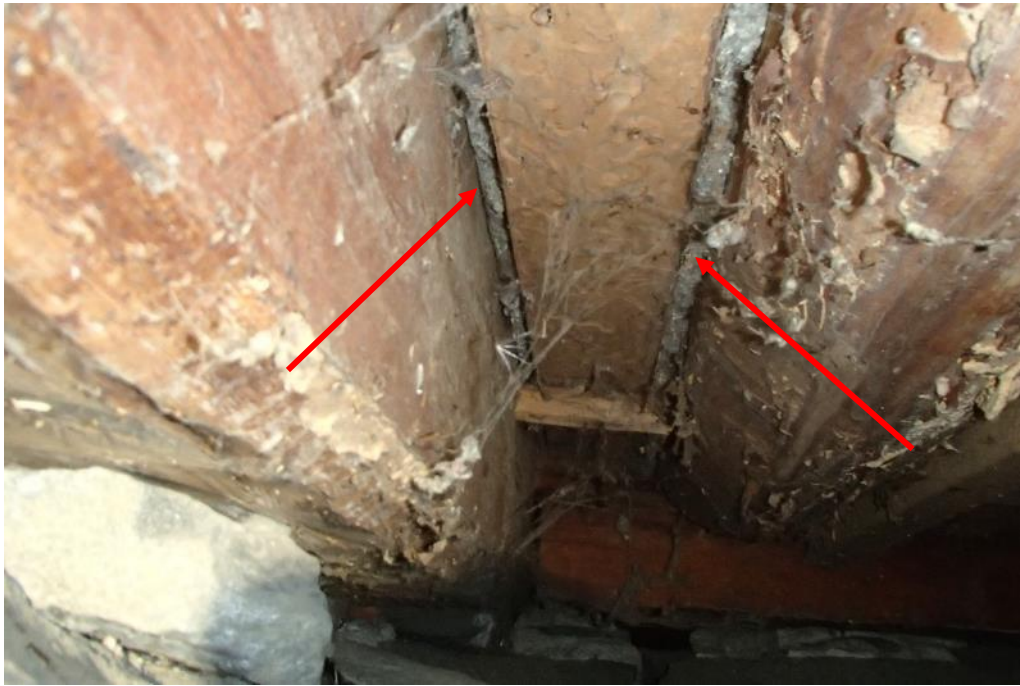
Kuva 13. Alapohjan ja väliseiniä reuna-alueilla ei ole tuulensuojalevyä. Peruskorjauksen yhteydessä selluvillat on asennettu vanhojen alalautojen päälle.
