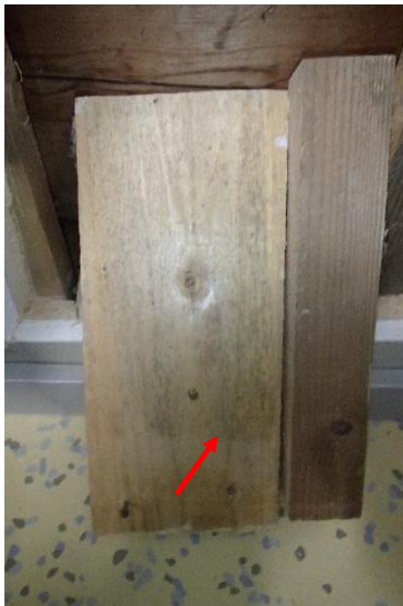
Kuva 74. Pystyлаudoituksissa havaittiin paikoin sinistäjäsiementä.
