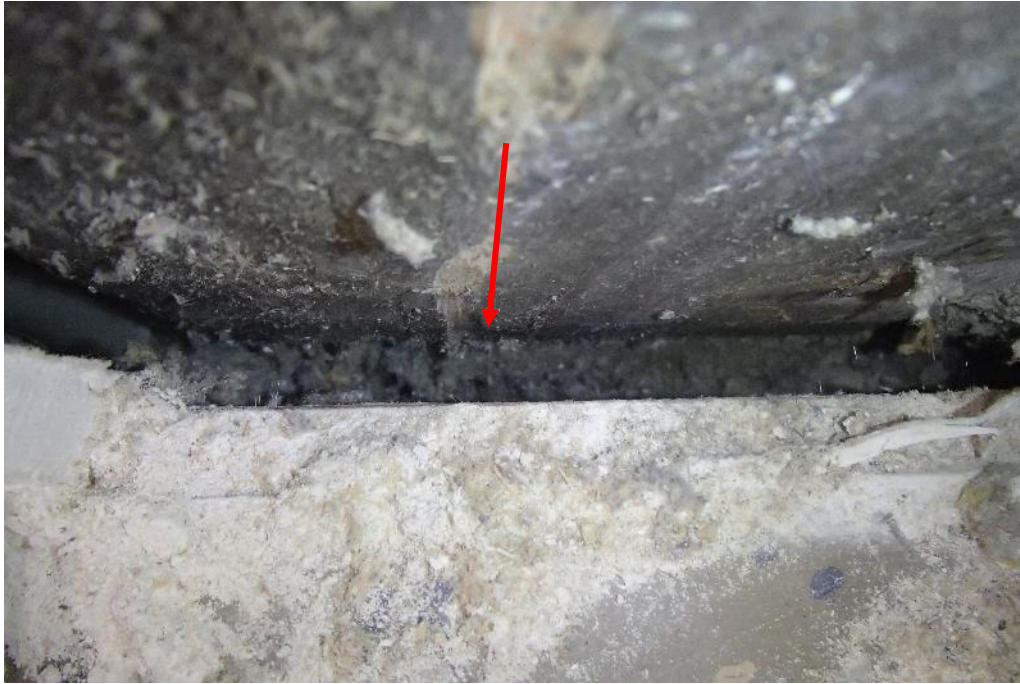
Kuva 83. Luokkahuoneen alapohjan ja hirsirungon rajapinnoilla havaittiin eristeet.
