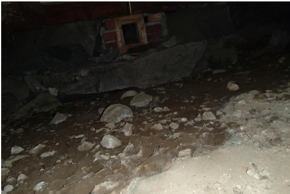
Kuva 28. Ryömintätilan maapinnat ovat kosteita pääosin sokkelin vierestä.
