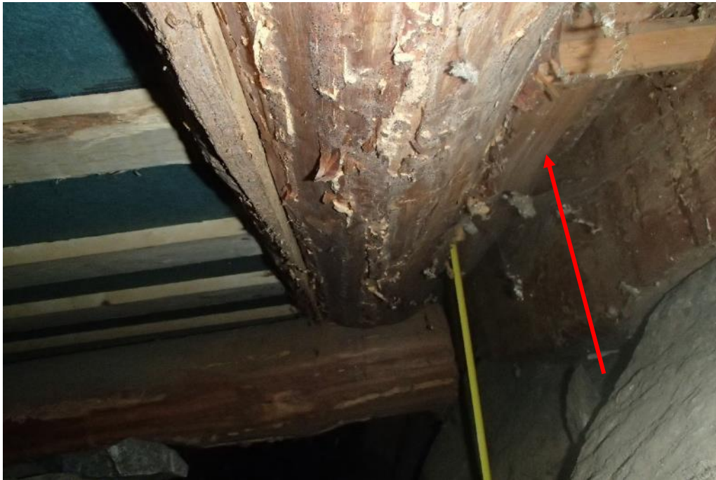
Kuva 11. Alapohjan ja väliseinien reuna-alueilla ei ole tuulensuojalevyä.
