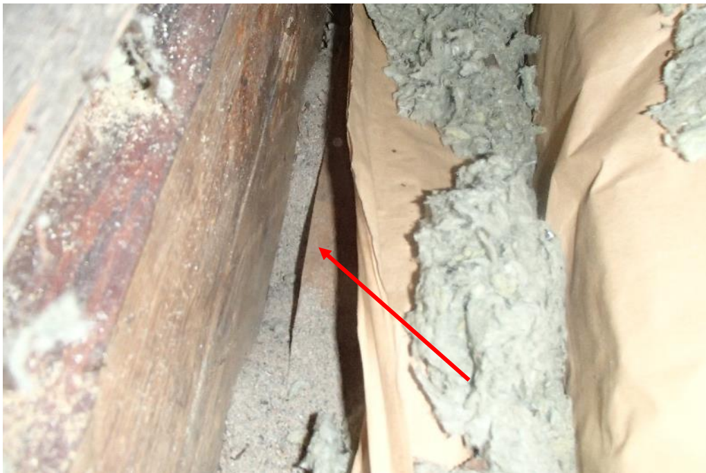
Kuva 49. Yläpohjarakenteiden ilmasulkupaperia ei ole asennettu tiiviisti.
