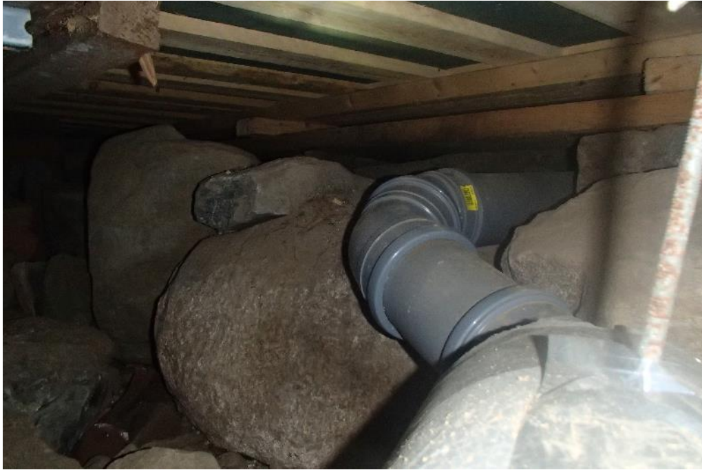
Kuva 23. Paikoin viemäriputkia on jätetty eristämättä.
