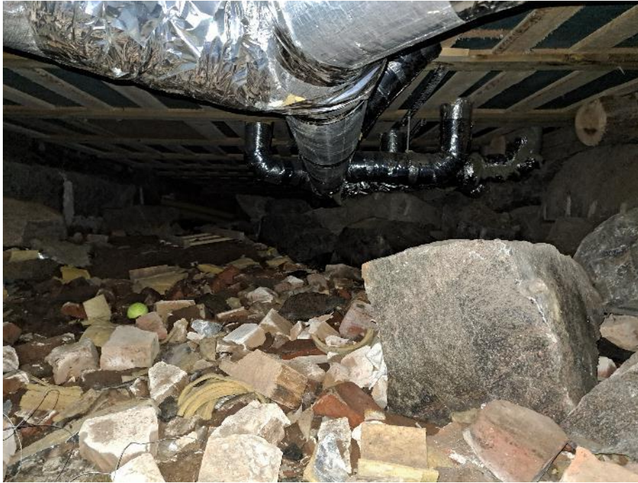
Kuva 27. Ryömintätilassa on jonkin verran ylimääräistä roskaa ja orgaanista materiaalia.
