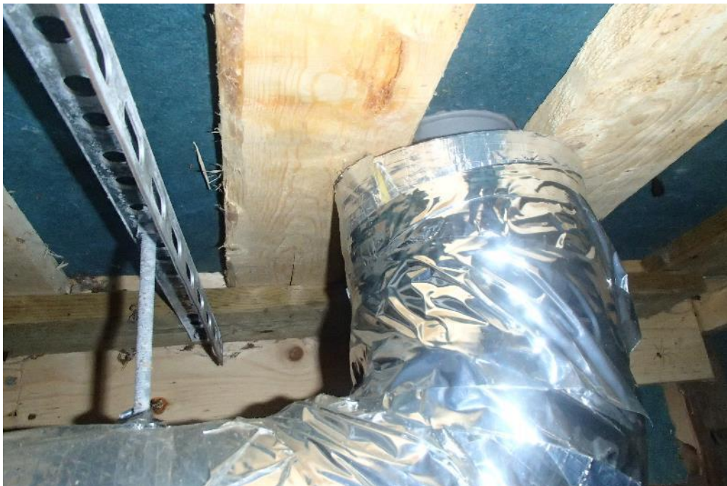
Kuva 22. Viemäriputket on eristetty ryömintätilan puolelta.
