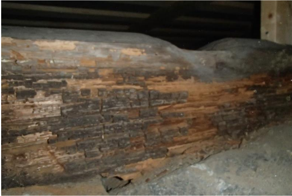
Kuva 17. Musiikkiluokan keskilinan kantavassa puupalkissa havaittiin laho- ja hyönteisvaurioita.
